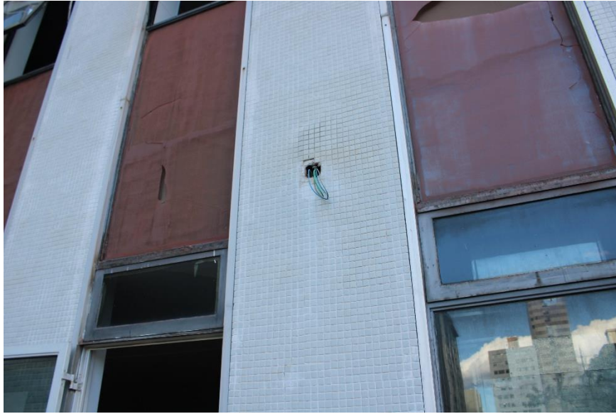
Figura 231 – Fios elétricos expostos - 2º pavimento
