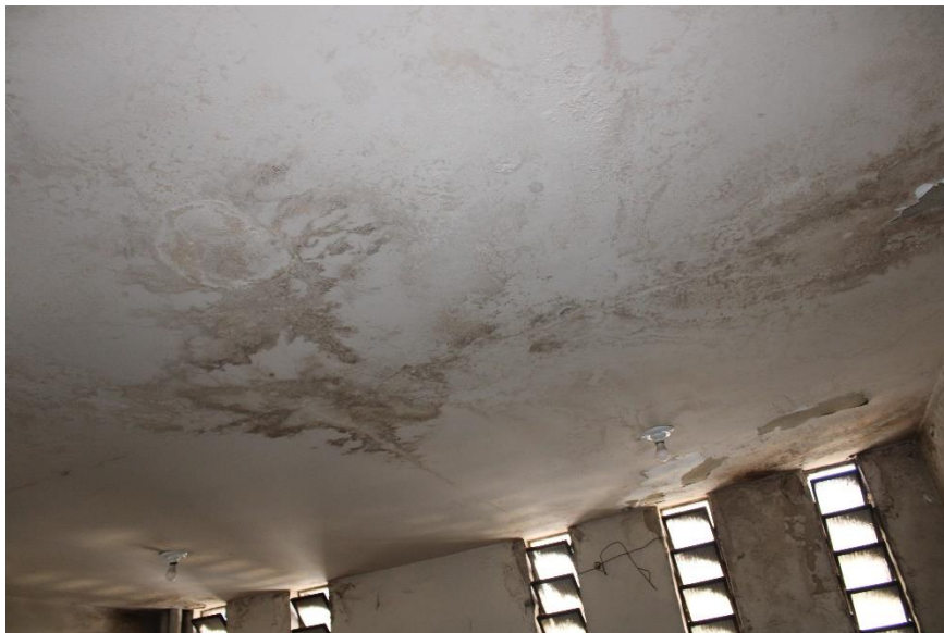
Figura 117 – Manchas de umidade no teto – casa de máquinas
