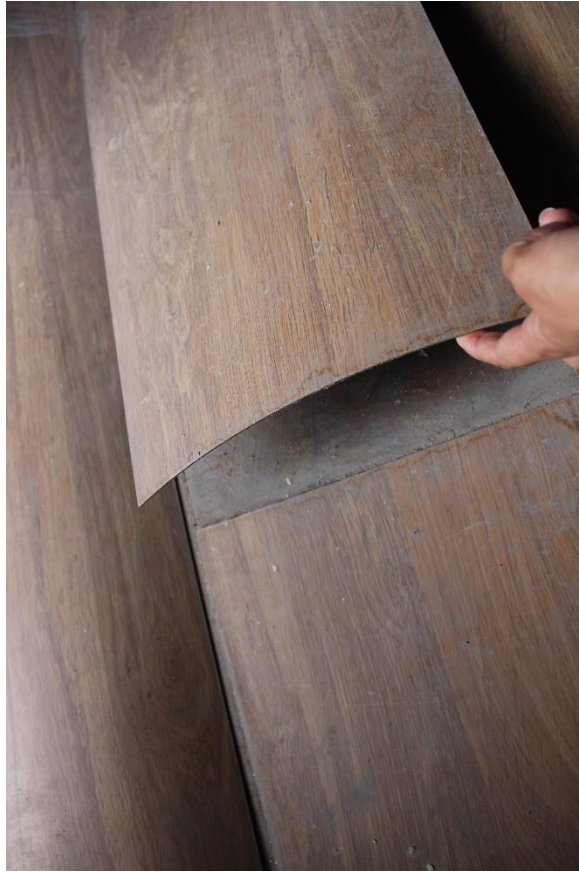
Figura 54 – Piso de madeira descolado
