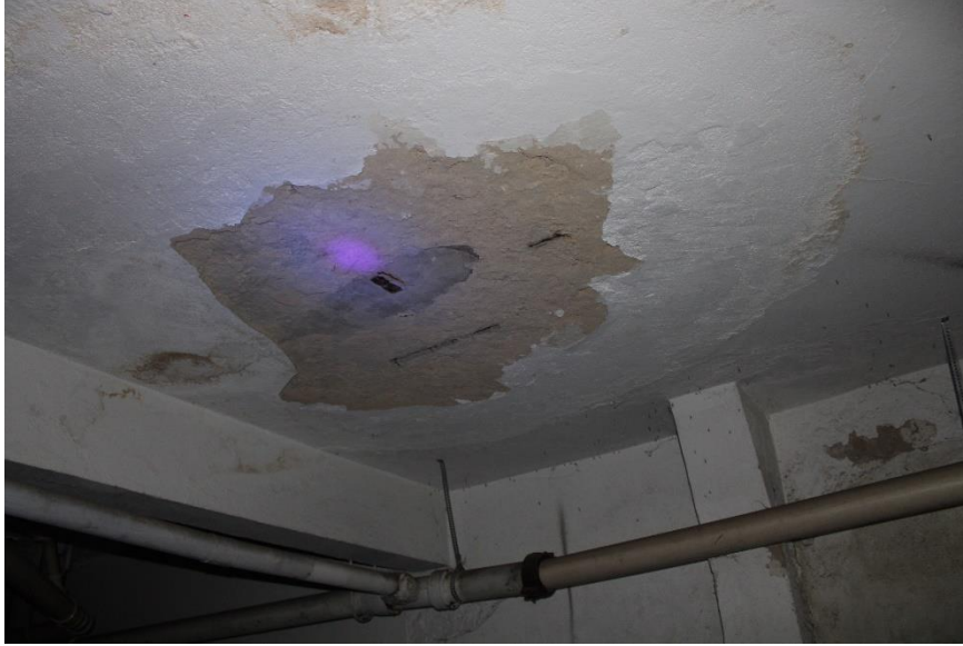
Figura 299 – Ferragem exposta no fundo da laje e manchas de umidade – garagem
