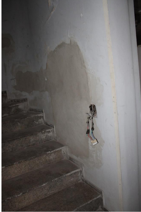
Figura 155 – Fios expostos em desconformidade com a NBR 5410 - - caixa de escada 5º ao 4º pavimento
