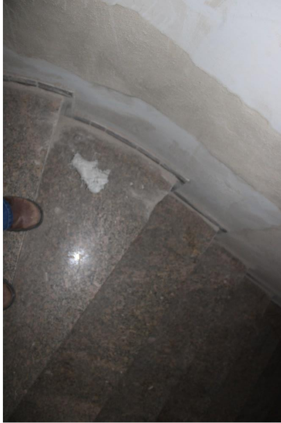
Figura 153 - Peças de granito quebrada e degraus sem fita antiderrapante – caixa de escada 5º ao 4º pavimento
