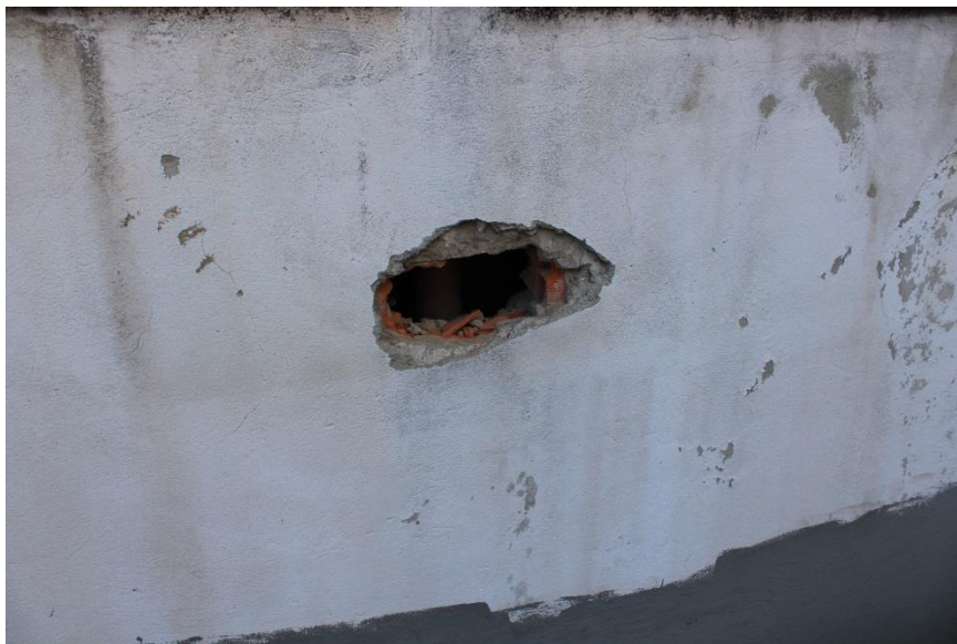
Figura 14 – Vista buraco na parede sem vedação adequada
