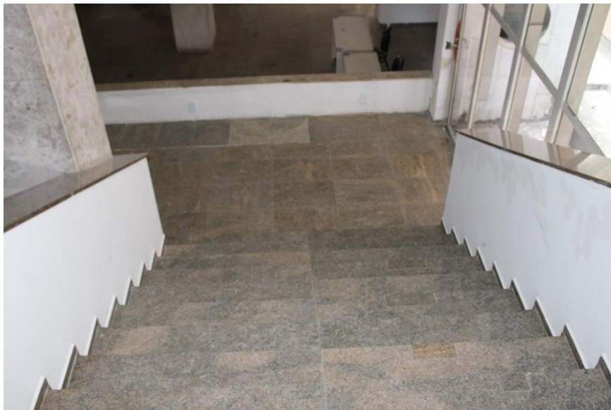
Figura 286 – Escada de acesso ao mezanino sem fitas antiderrapantes
