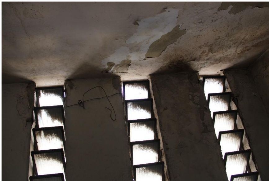
Figura 111 – Descascamento de pintura e manchas de umidade na parede e teto – casa de máquinas
