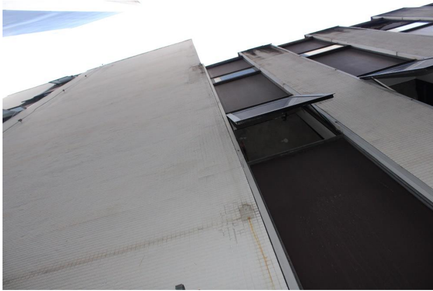
Figura 211 – Fachada apresentando sujidades – área externa 3º pavimento
