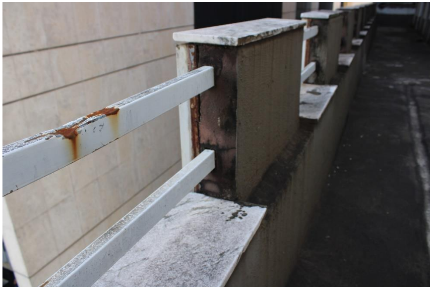
Figura 69 – Guarda-corpo oxidado e amassado
