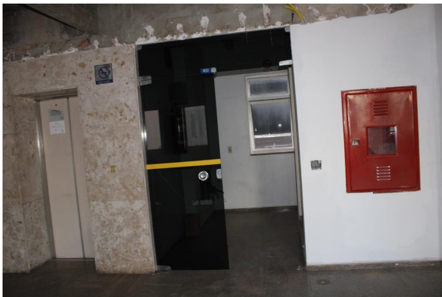
Figura 173 – Vista parcial hall 4º pavimento – peças de mármore apresentando som cavo
