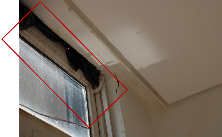
Figura 191 – Rachadura e manchas de umidade na parede – 3º pavimento
