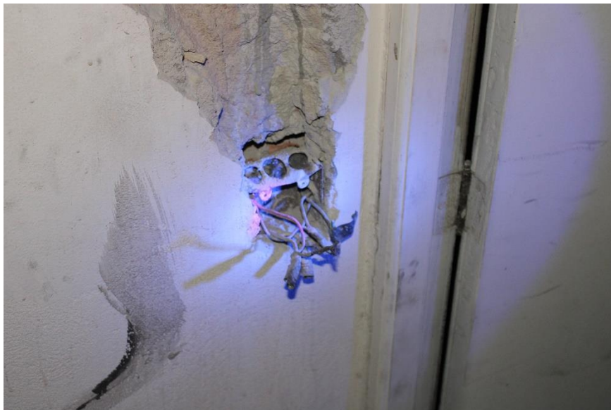
Figura 101 – Fios expostos na caixa de escada
