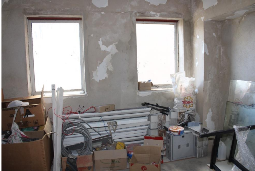
Figura 134 - Descascamento da pintura – 5º pavimento – mezanino
