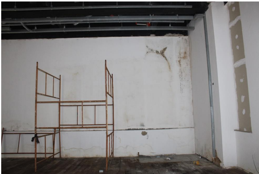
Figura 163 - Vista parcial manchas de umidade e mofo nas paredes - 4º pavimento
