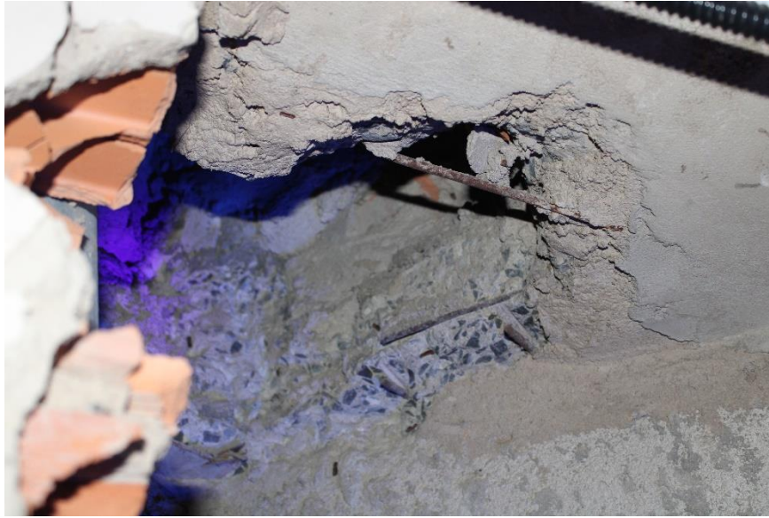
Figura 104 – Furos no concreto com ferragem aparente
