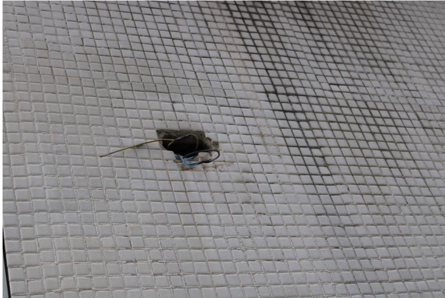
Figura 207 – Vista furo na fachada com fios expostos - área externa 3º pavimento
