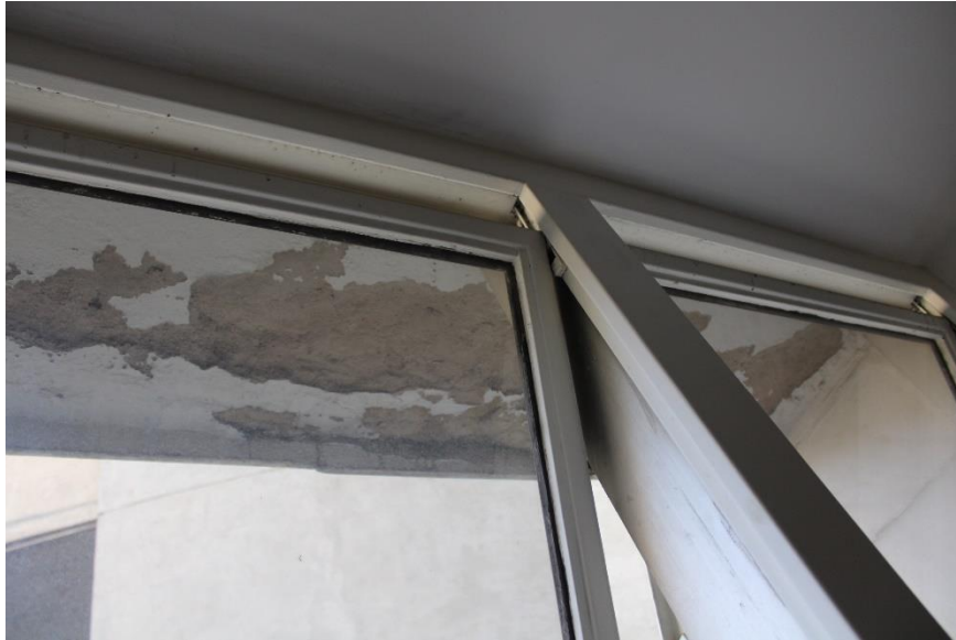
Figura 239 – Deslocamento de massa – beiral 1º pavimento
