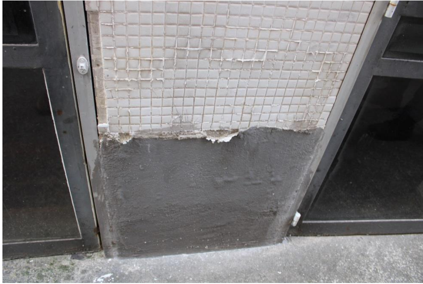
Figura 197 – Vista parcial descolamento da impermeabilização – área externa 3º pavimento
