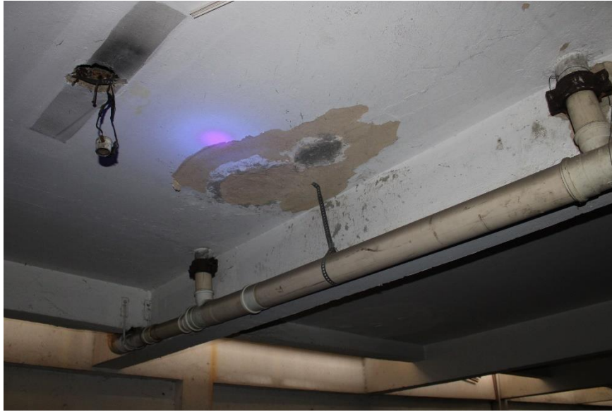
Figura 297 – Deslocamento de massa e pintura do teto e fios elétricos expostos – garagem
