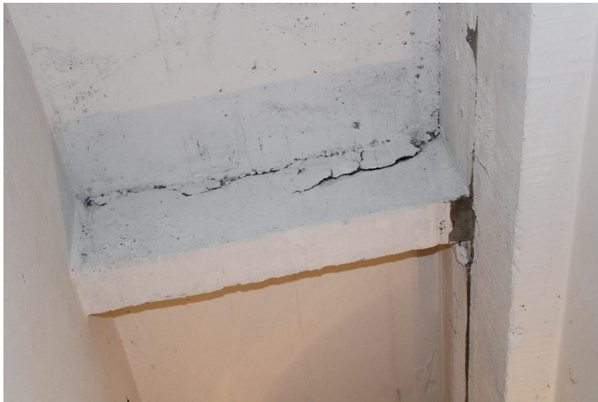
Figura 241 – Descolamento de massa da viga – anexo 1º pavimento
