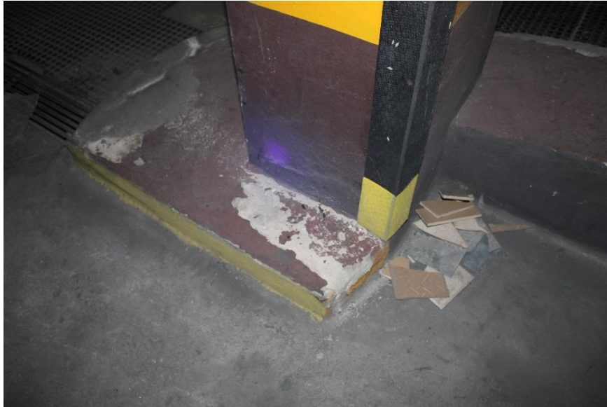
Figura 333 – Vista piso danificado – garagem
