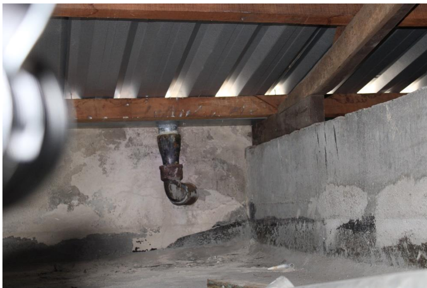
Figura 93 – Vista tubulação de ferro em processo de oxidação
