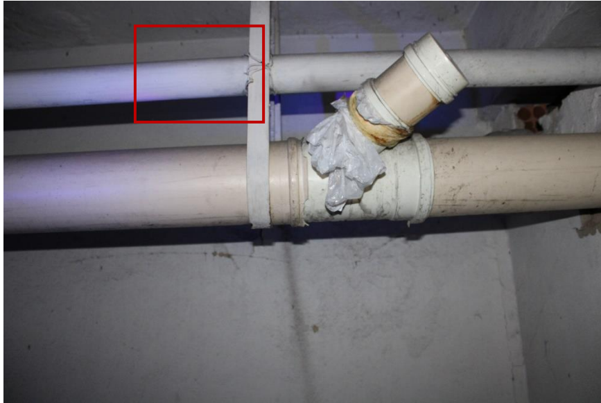
Figura 321 – Vista vedação da tubulação com sacola de plástico e fitas de sustentação presas com fios – garagem
