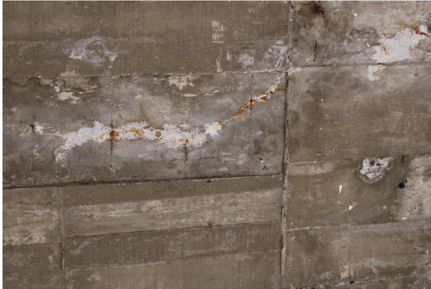
Figura 190 – Eflorescências e manchas de ferrugem na laje
