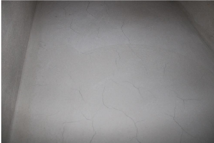
Figura 144 – Mapeamento de fissuras – 5º pavimento – mezanino
