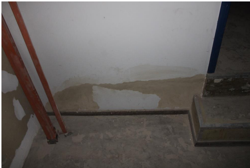
Figura 129 – Descascamento de pintura
