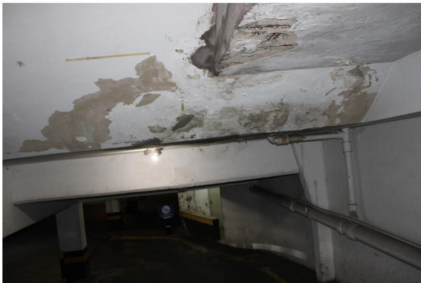
Figura 337 – Evidências de umidade no fundo da laje da escada – rampa garagem
