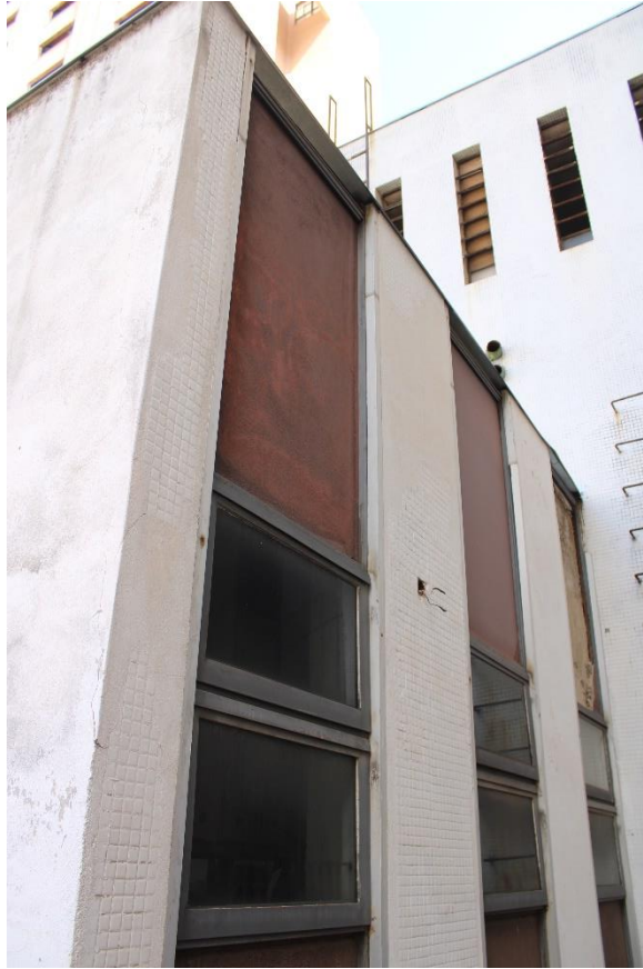
Figura 21 – Vista parcial fachada lateral direita com fio elétrico exposto
