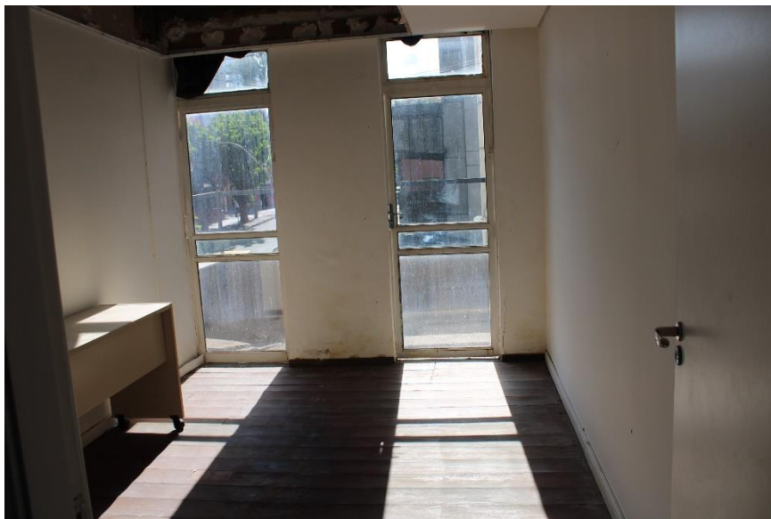
Figura 188 – Forro de gesso danificado, portas com frestas e pontos de oxidação – 3º pavimento
