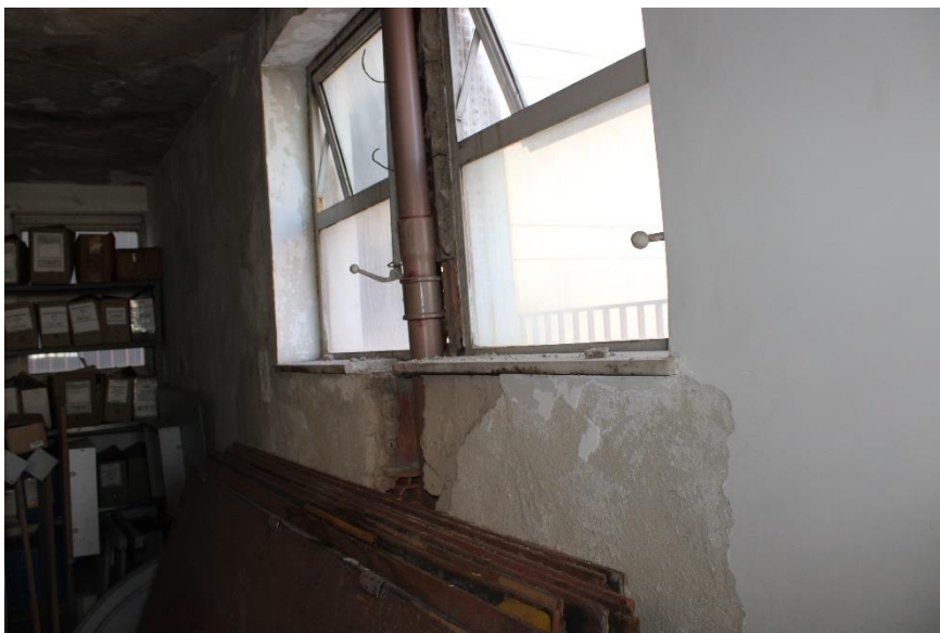
Figura 36 – Rasgo para passagem de tubulação sem fechamento adequado – sala 6º pavimento (arquivo)
