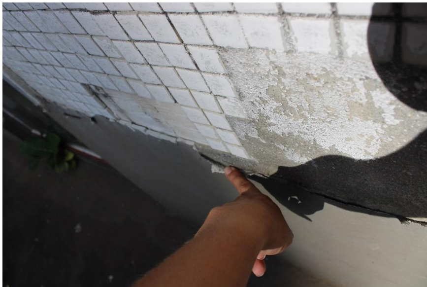
Figura 81 – Manta feita sobre pastilhas que estão deslocando
