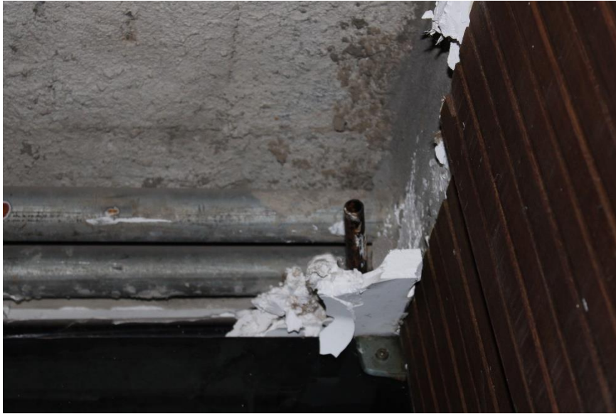
Figura 42 – Vista tubulações no teto – hall 6º pavimento
