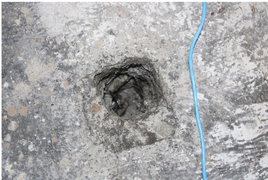
Figura 265 – Ralo sem vedação – lateral esquerda
