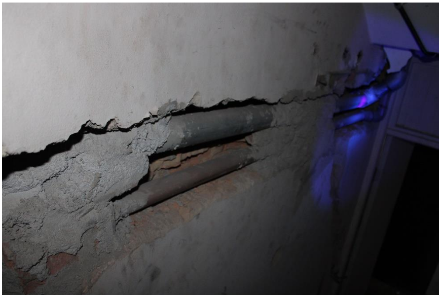
Figura 103 – Vista parcial tubulações passando pela caixa de escada
