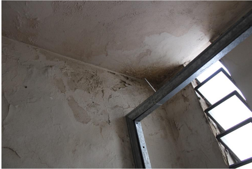
Figura 116 – Descascamento de pintura – casa de máquinas
