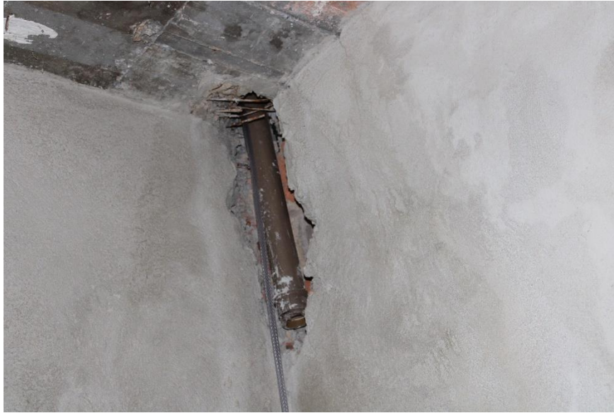
Figura 62 – Vista tubulação e laje com ferragem exposta – 6º pavimento
