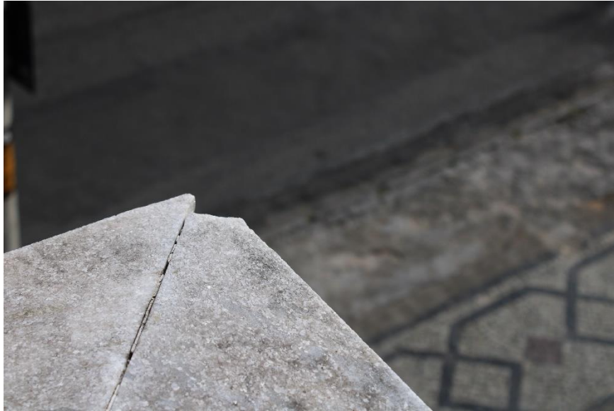
Figura 215 – Peitoril quebrado – área externa 3º pavimento
