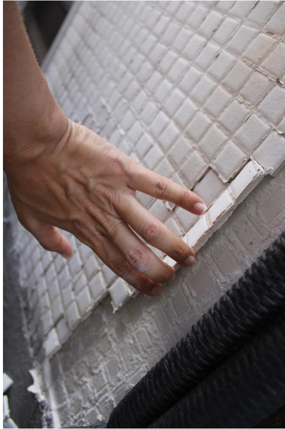
Figura 201 – Vista deslocamento do revestimento da fachada – área externa 3º pavimento
