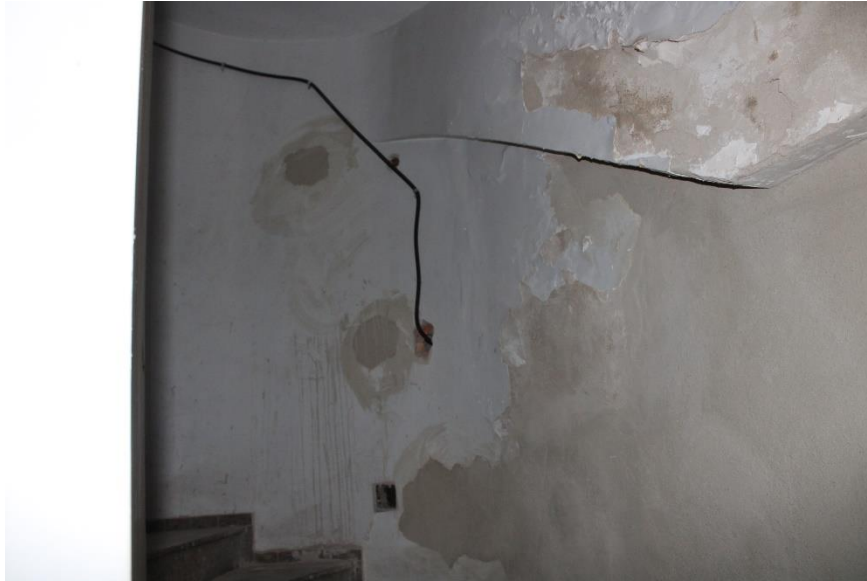
Figura 150 - Evidências de umidade nas paredes e teto – 5º pavimento – mezanino
