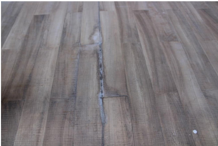
Figura 259 – Eflorescência no piso – área externa fundos
