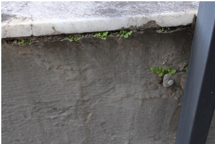
Figura 232 – Vegetação atrás da manta líquida no guarda-corpo – 2º pavimento
