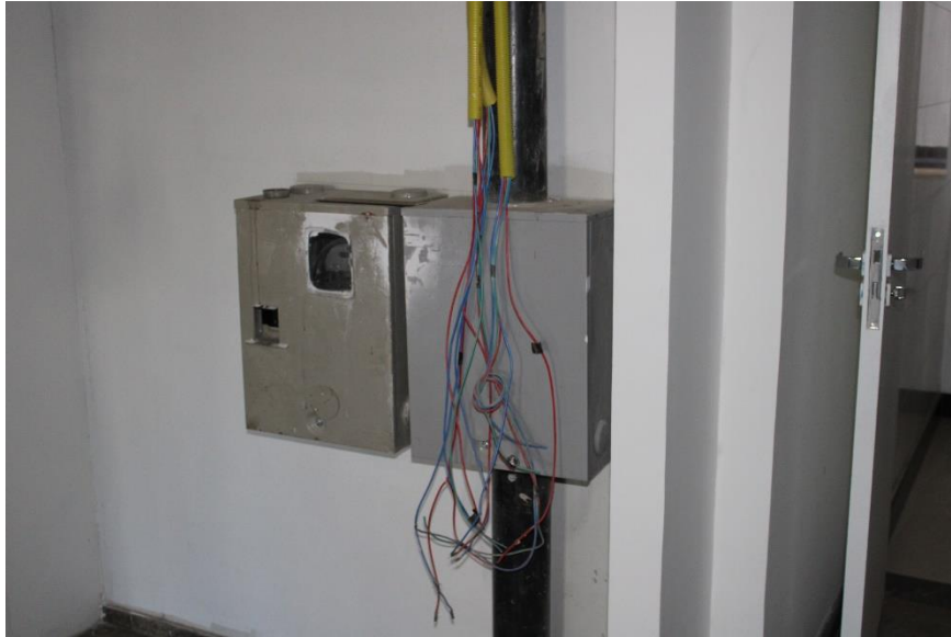
Figura 172 – Fios expostos – 4º pavimento
