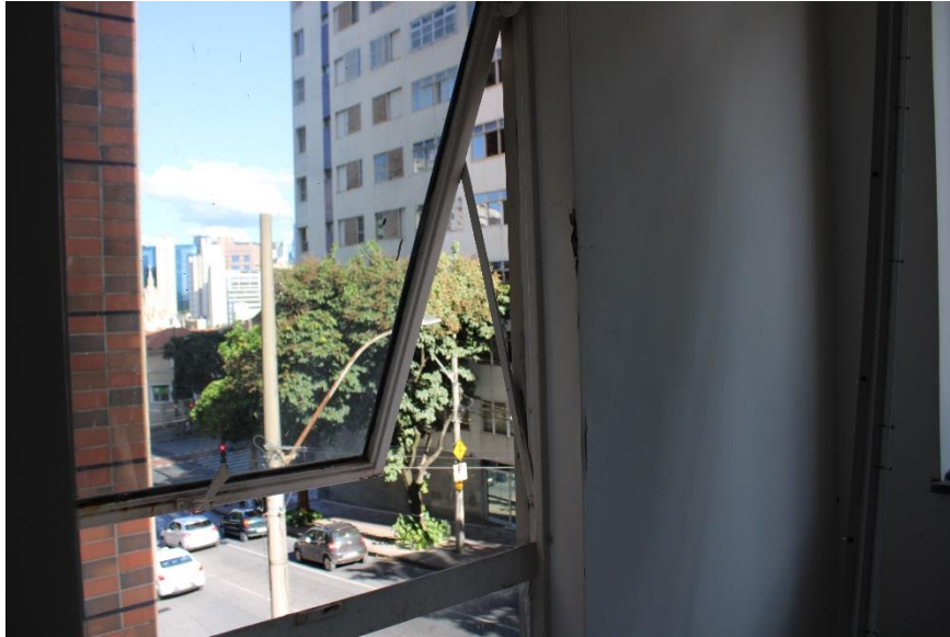
Figura 180 – Vista janela com pontos de oxidação – 3º pavimento
