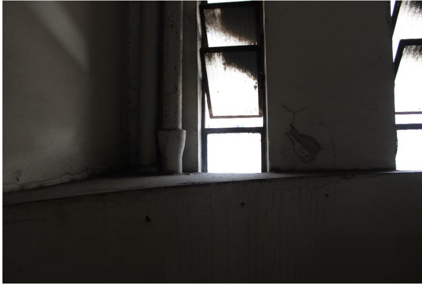
Figura 118 – Descascamento de pintura – caixa de escada
