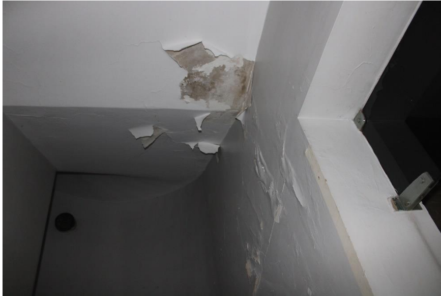
Figura 156 – Descascamento de pintura – caixa de escada 5º ao 4º pavimento
