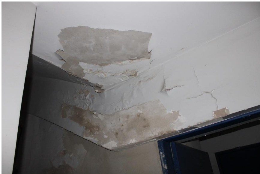
Figura 149 – Evidências de umidade nas paredes e teto – 5º pavimento – mezanino
