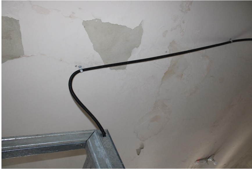
Figura 114 - Manchas de umidade no teto – casa de máquinas
