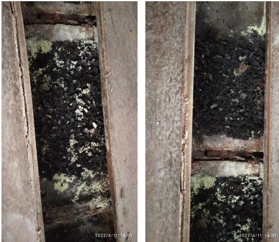
Figura 58 - Vista terra encontrada sob o piso laminado – 6º pavimento
