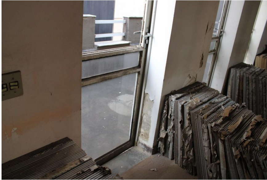
Figura 50 – Descascamento de pintura na base das paredes – 6º pavimento
