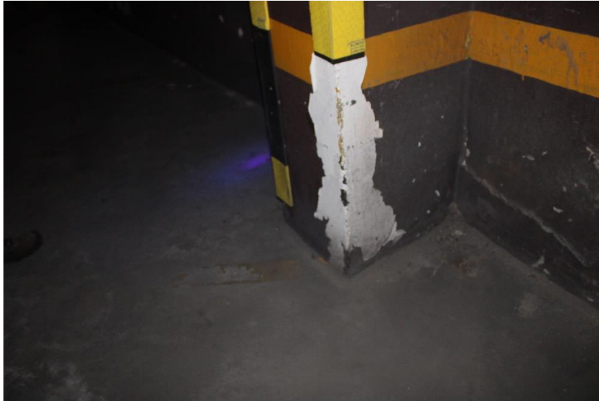
Figura 331 – Descascamento de pintura na base do pilar – garagem
