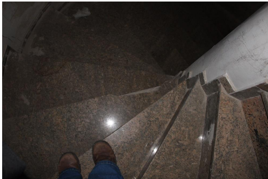
Figura 152 – Peças de granito quebrada e degraus sem fita antiderrapante – caixa de escada 5º ao 4º pavimento
