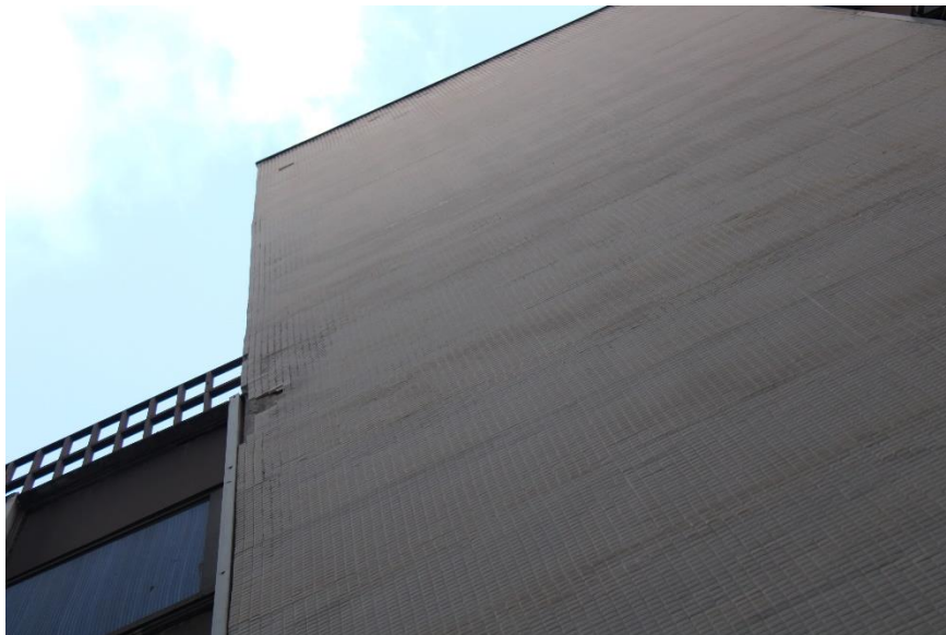
Figura 208 – Vista deplacamento do revestimento da fachada – área externa 3º pavimento
