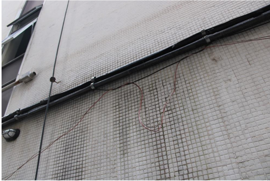
Figura 209 – Fios expostos e canaletas passando próximo ao SPDA - área externa 3º pavimento
