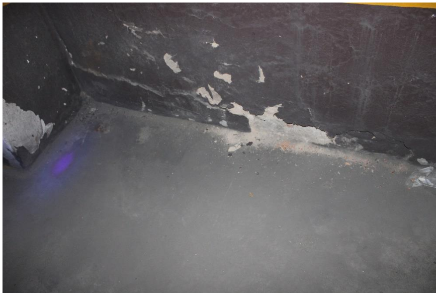
Figura 330 – Mapeamento de fissuras e trincas, e descascamento de pintura na base da parede – garagem
