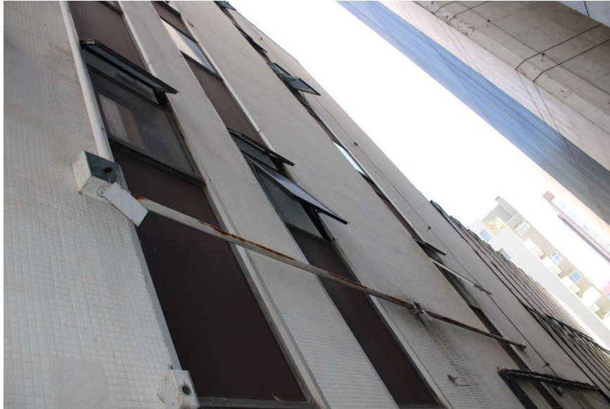
Figura 205 – Vista canaleta enferrujada e sem uso – área externa 3º pavimento
