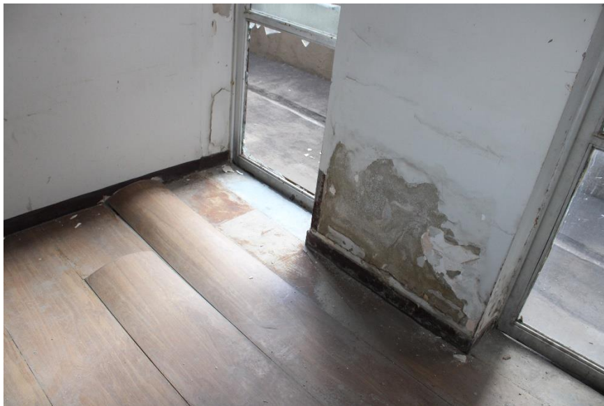
Figura 53 – Descascamento de pintura na base das paredes – 6º pavimento
