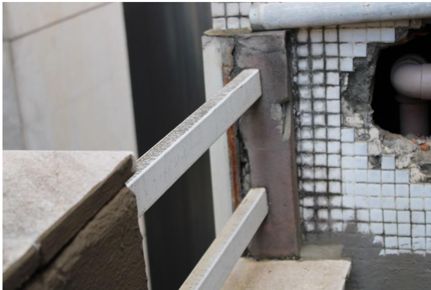
Figura 77 – Estrutura guarda-corpo degradada
