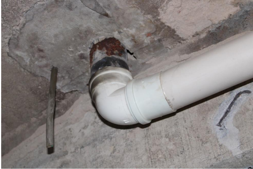
Figura 124 – Vista tubulação – 5º pavimento mezanino
