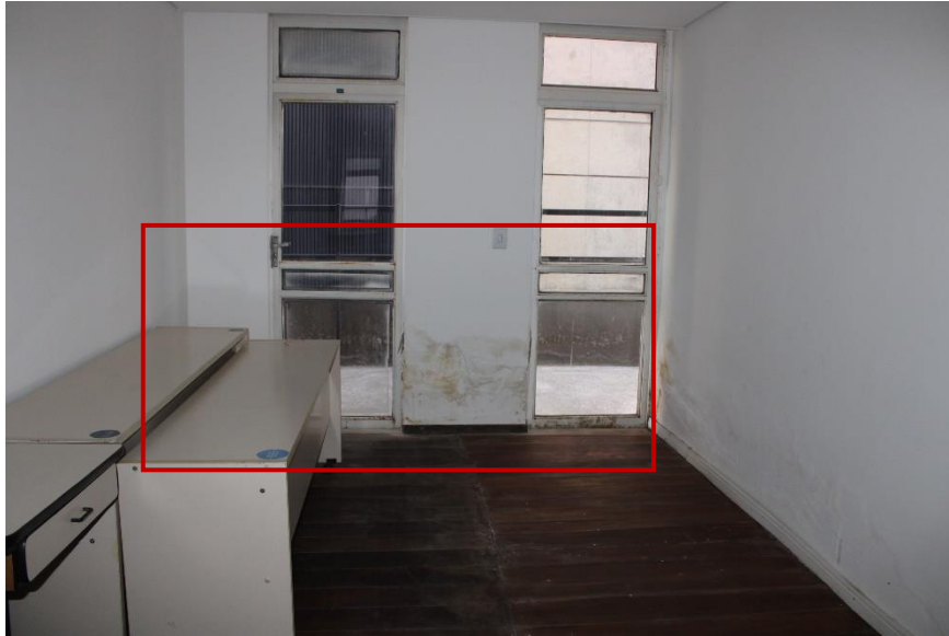
Figura 195 - Manchas de umidade na parede – 3º pavimento
