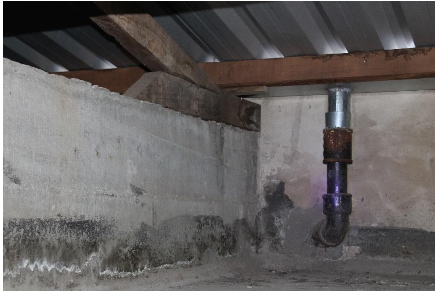
Figura 94 – Vista tubulação de ferro em processo de oxidação
