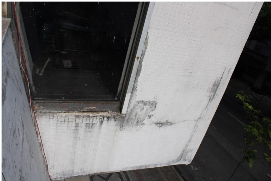
Figura 218 - Vista fachada lateral e esquadria metálica oxidada
