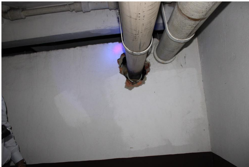
Figura 320 – Paredes quebradas para a passagem da tubulação – garagem
