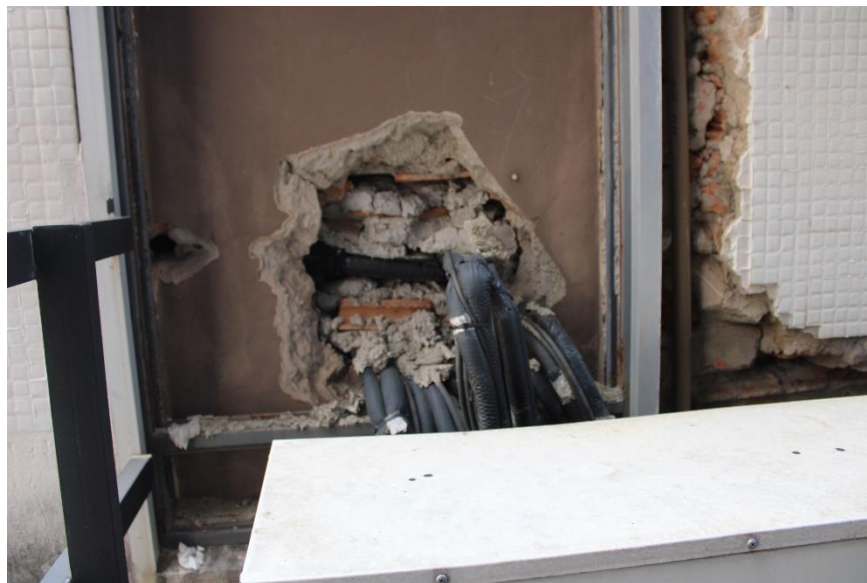
Figura 203 – Furos para passagem de tubulações sem a vedação adequada – área externa 3º pavimento
