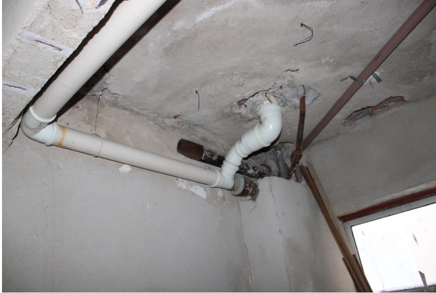
Figura 122 - Vista tubulação e furo na laje – 5º pavimento mezanino
