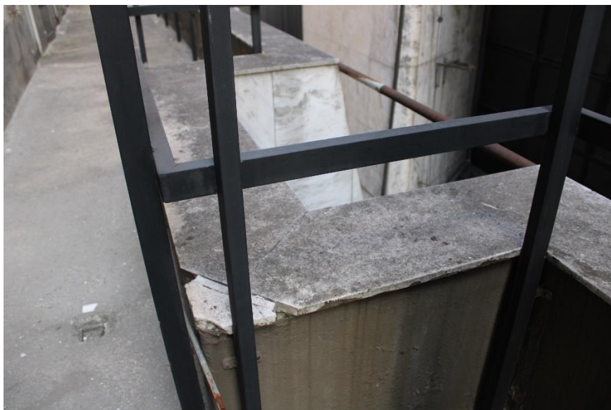
Figura 206 – Vista guarda-corpo danificado – área externa 3º pavimento
