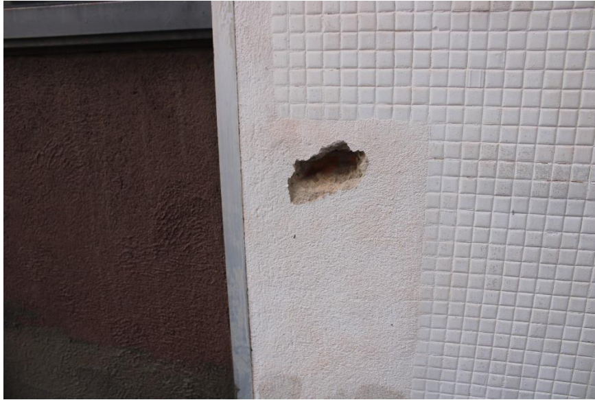
Figura 23 - Vista furo na fachada lateral direita
