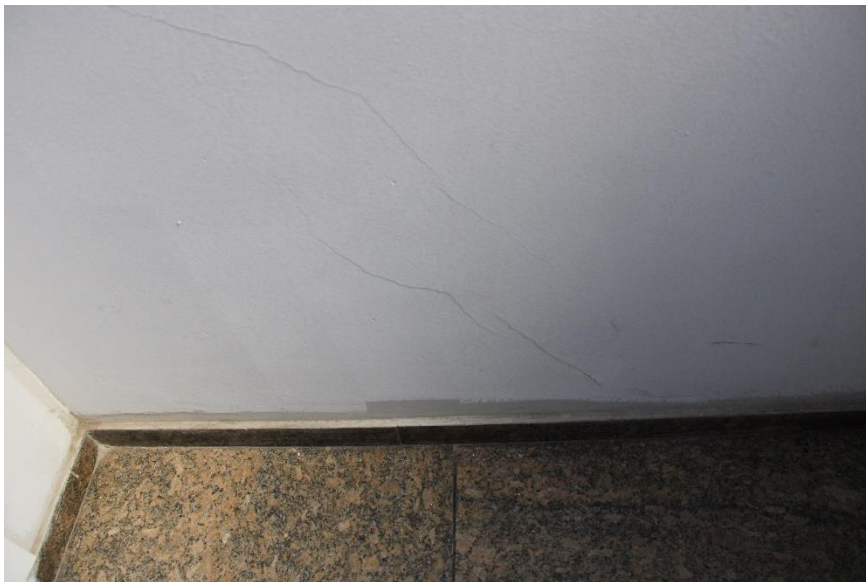
Figura 169 - Fissuras inclinadas na base da parede – 4º pavimento
