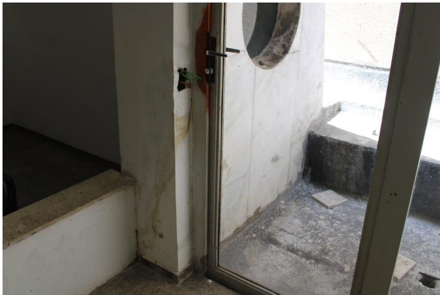
Figura 281 – Manchas de umidade e fios expostos – salão térreo
