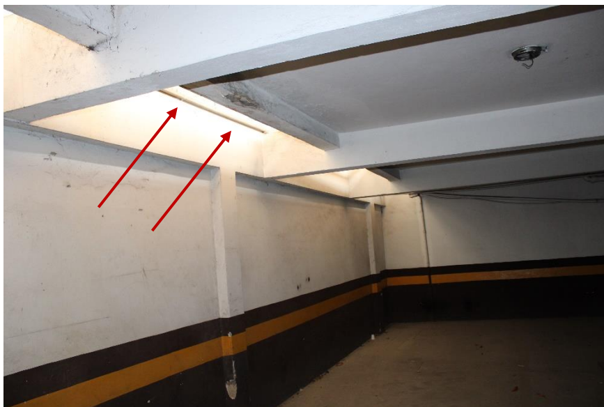
Figura 308 – Vista parcial garagem – trincas longitudinais na viga e manchas de umidade
