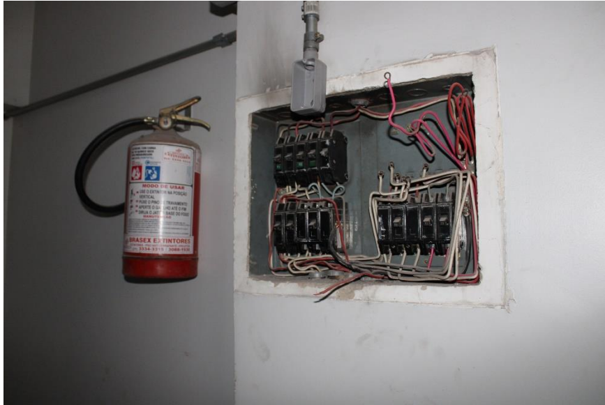
Figura 151 – Caixa sem tampa com acondicionamento em desconformidade com a NBR 5410
