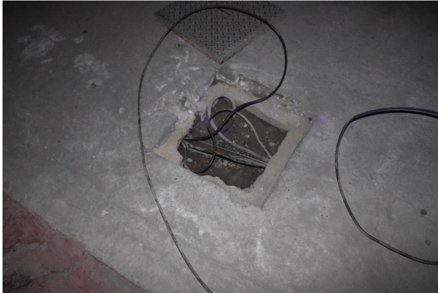
Figura 327 – Fios expostos e caixa com tampa aberta – garagem
