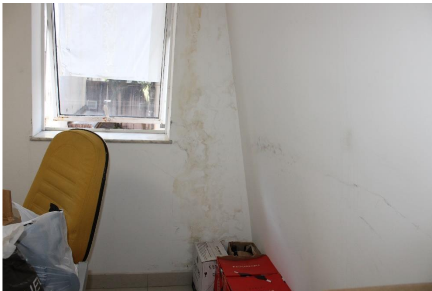
Figura 249 - Manchas de umidade na parede – 1º pavimento
