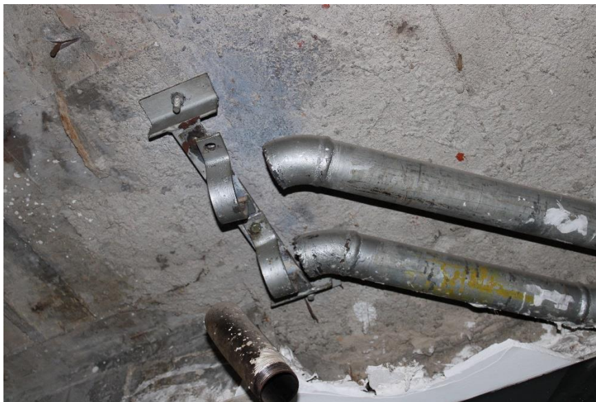
Figura 41 – Vista tubulações no teto – hall 6º pavimento
