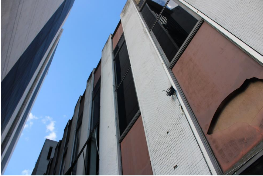
Figura 221 – Vidro quebrado, pontos sem revestimento na fachada lateral direita e fios expostos
