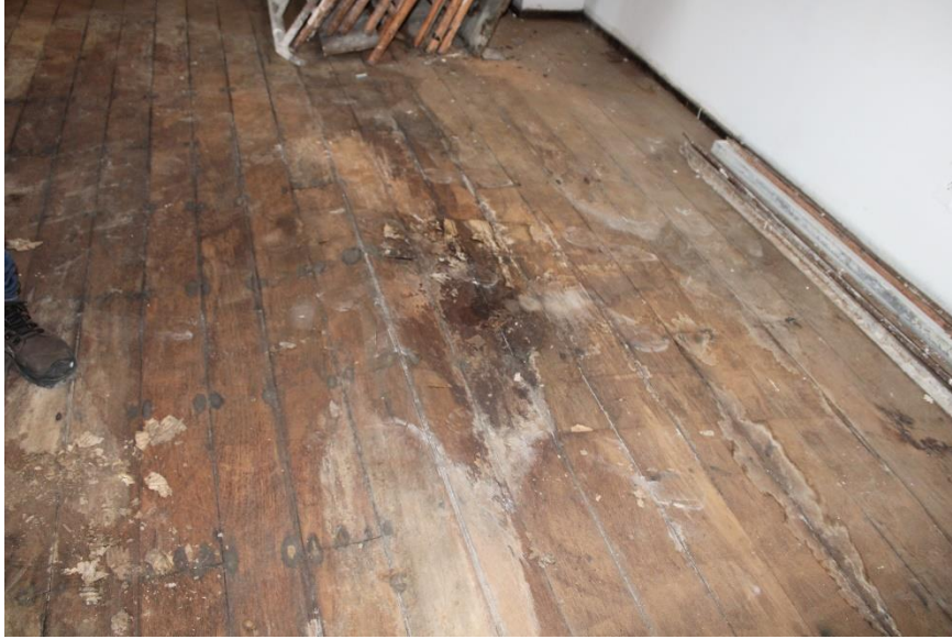
Figura 162 - Vista parcial piso degradado - 4º pavimento
