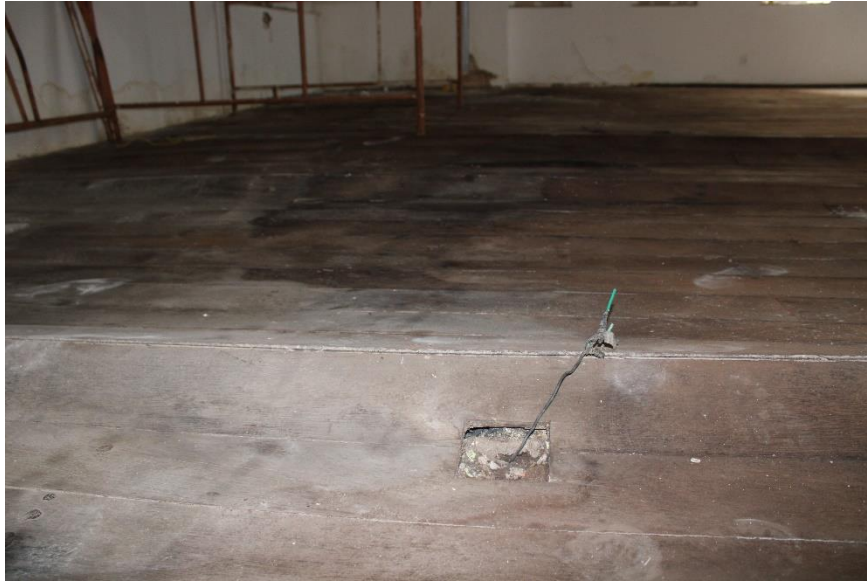
Figura 160 – Fio elétrico exposto no piso – 4º pavimento
