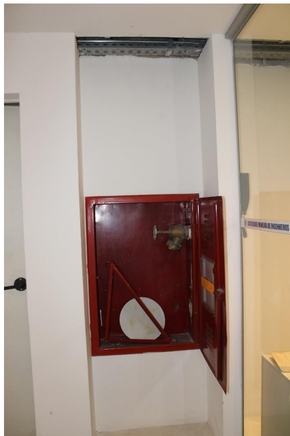
Figura 238 – Caixa de hidrante sem mangueira – 1º pavimento
