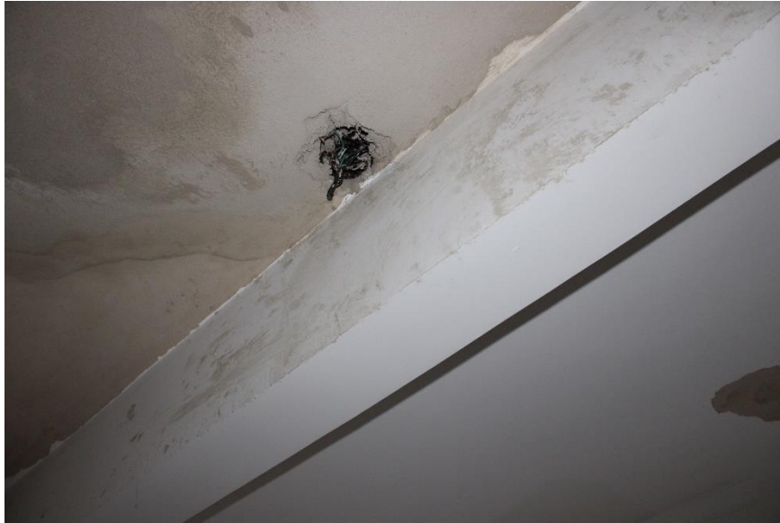
Figura 136 – Fios expostos – 5º pavimento – mezanino
