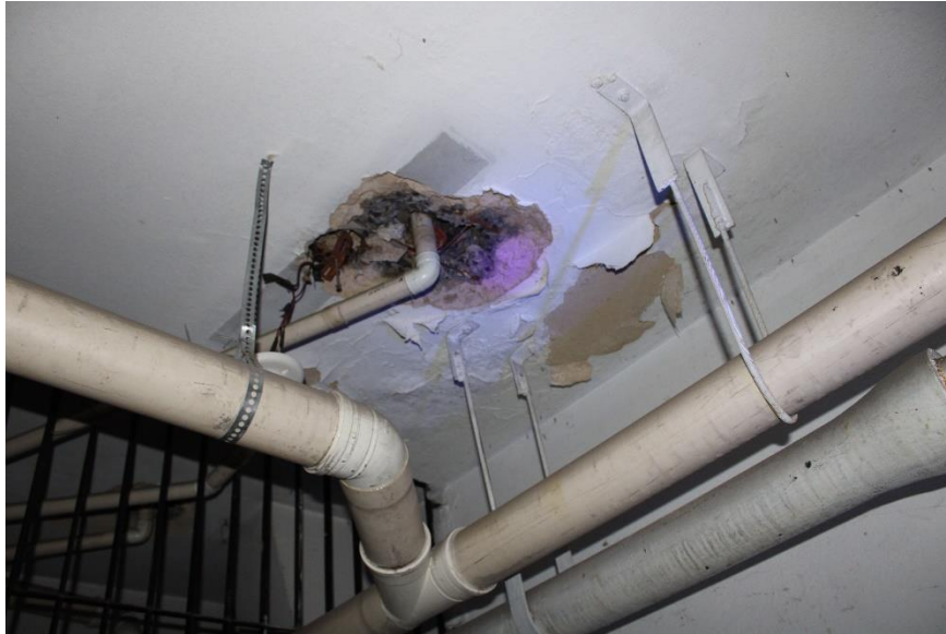
Figura 303 – Furo na laje com ferragem exposta, fios elétricos soltos e descascamento de pintura no teto – garagem
