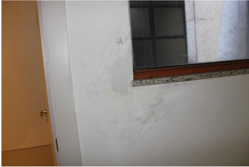
Figura 242 – Manchas de umidade e empolamento de pintura – 1º pavimento ( sala secretária)
