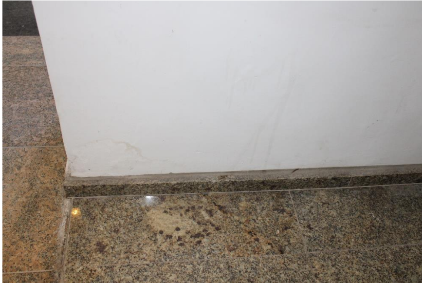
Figura 272 – Mancha de umidade na base da parede- pavimento térreo
