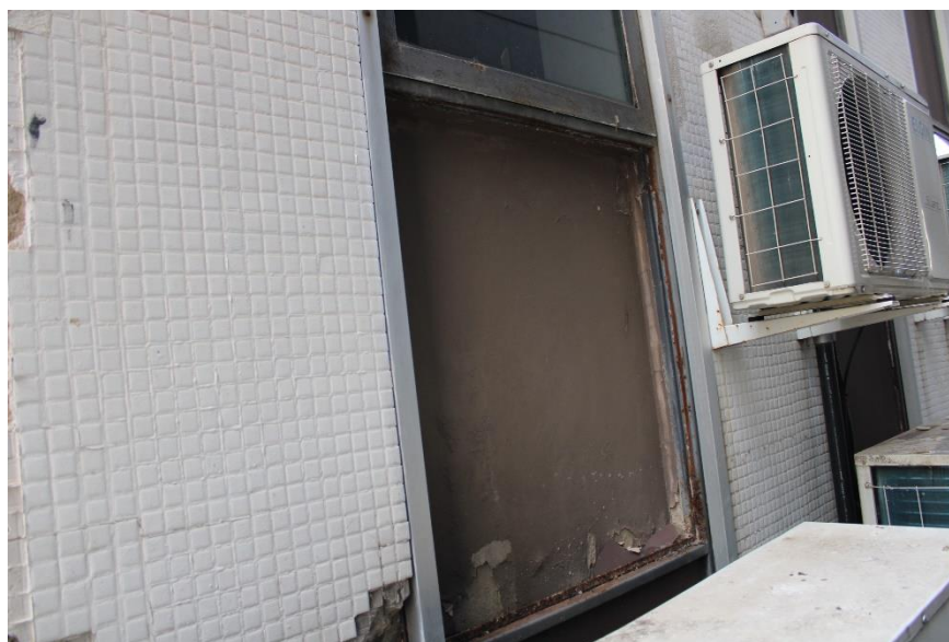
Figura 204 – Vidro de fechamento da fachada quebrado e oxidação da estrutura metálica de fixação – área externa 3º pavimento
