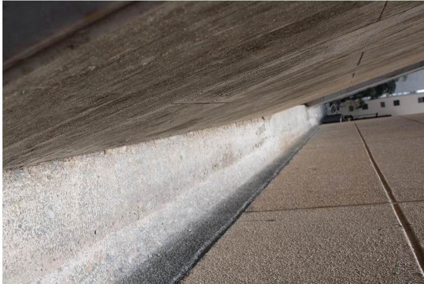
Figura 280 – Vista fachada lateral com sujidades e mofo
