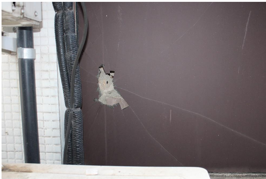
Figura 202 – Vidro de fechamento da fachada quebrado - área externa 3º pavimento
