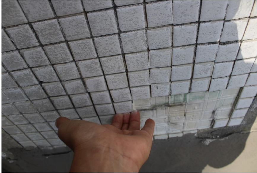
Figura 84 – Deslocamento de pastilhas fachada
