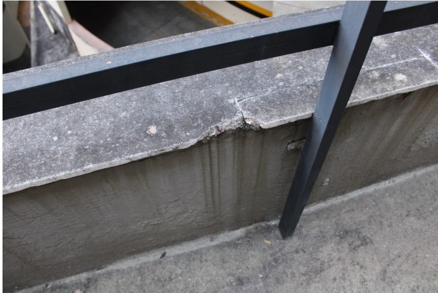
Figura 233 – Peitoril danificado – 2º pavimento
