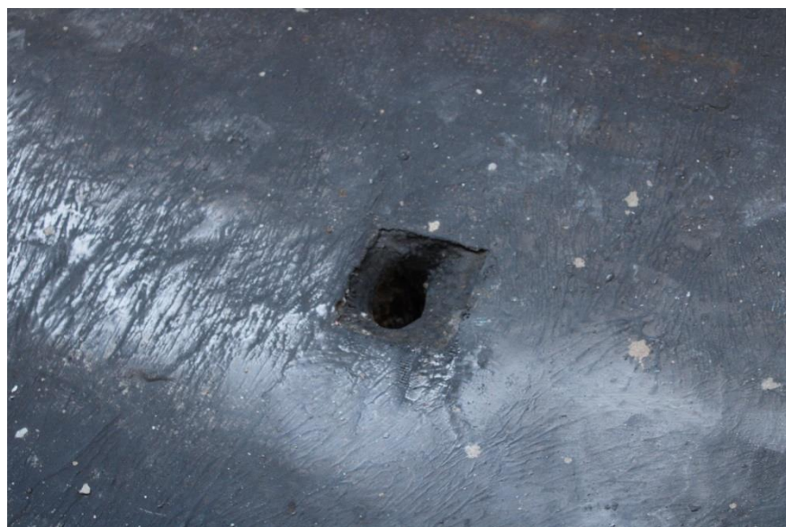
Figura 263 – Vista ralo sem vedação – lateral esquerda
