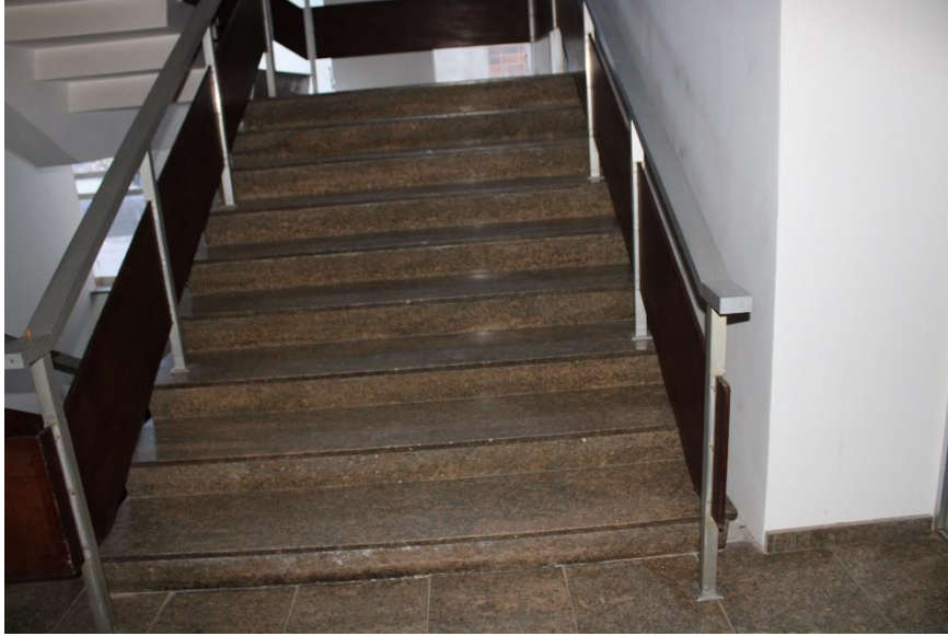
Figura 227 – Escada sem proteção antiderrapantes – 2º pavimento
