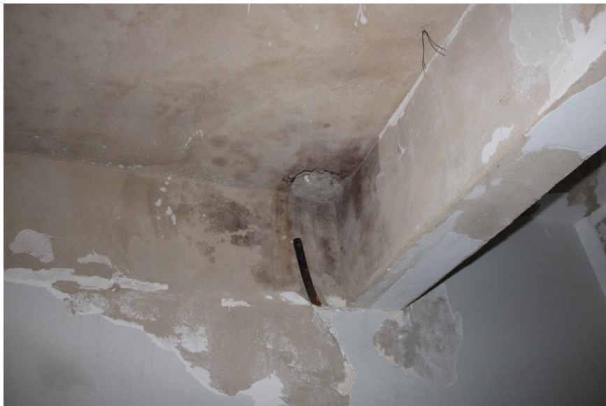
Figura 121 – Mancha de umidade e descascamento de pintura – 5º pavimento mezanino
