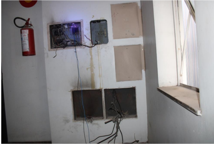
Figura 96 - Fiação exposta no hall de escada
