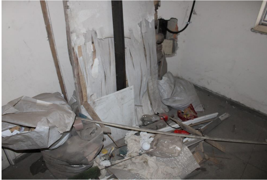
Figura 108 – Vista entulhos na caixa de escada de acesso à casa de máquinas
