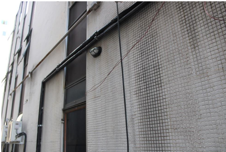
Figura 210 - Fios expostos e canaletas passando próximo ao SPDA - área externa 3º pavimento
