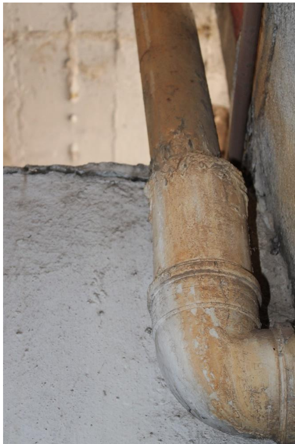
Figura 296 – Vista tubulação – garagem
