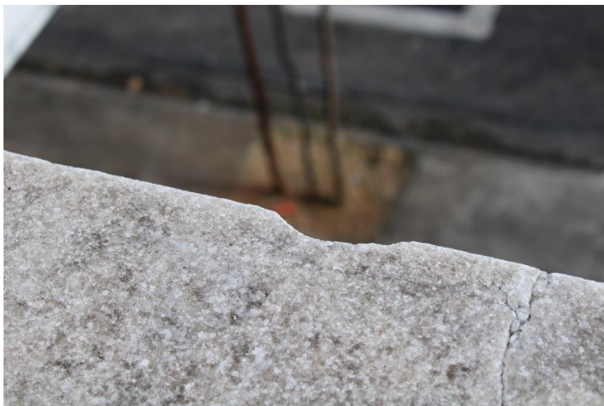
Figura 216 - Peitoril quebrado – área externa 3º pavimento
