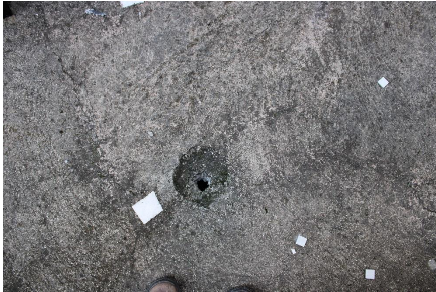
Figura 213 – Possivelmente um ponto de ralo obstruído– área externa 3º pavimento
