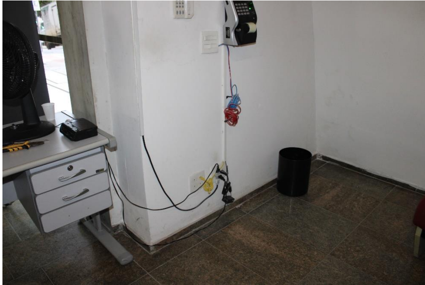
Figura 270 – Vista recepção com manchas de umidade
