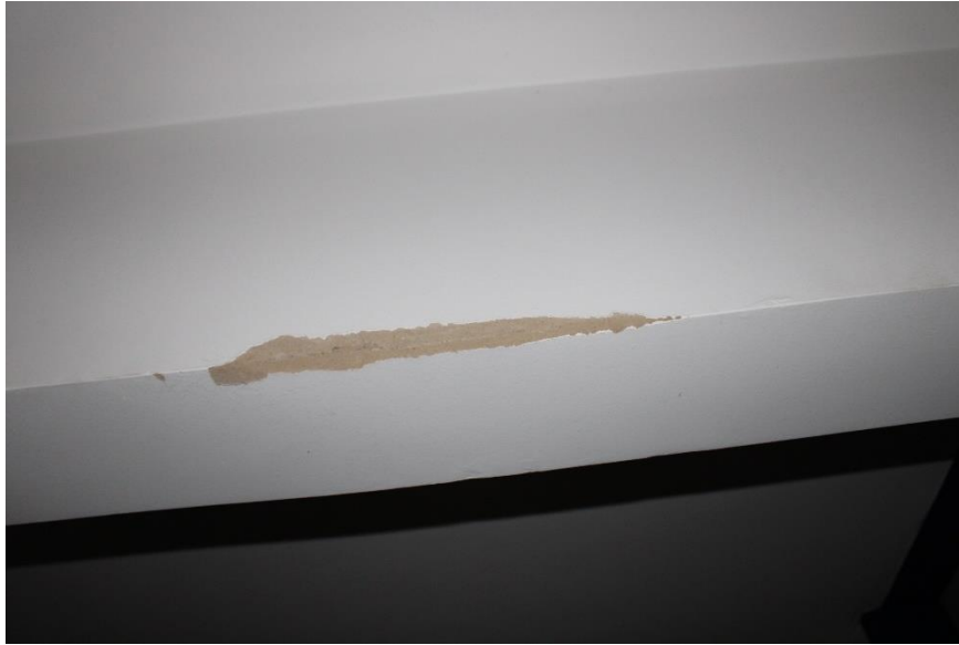
Figura 128 – Descascamento de pintura
