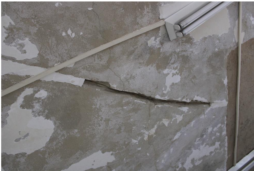
Figura 30 – Detalhe rasgo na laje – sala 6º pavimento
