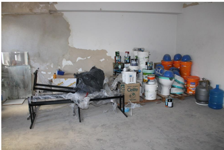
Figura 133 – Descascamento da pintura – 5º pavimento – mezanino
