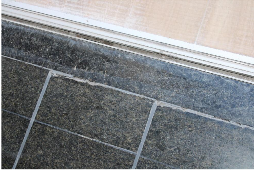
Figura 274 - Desgaste no rejuntamento do piso – salão térreo
