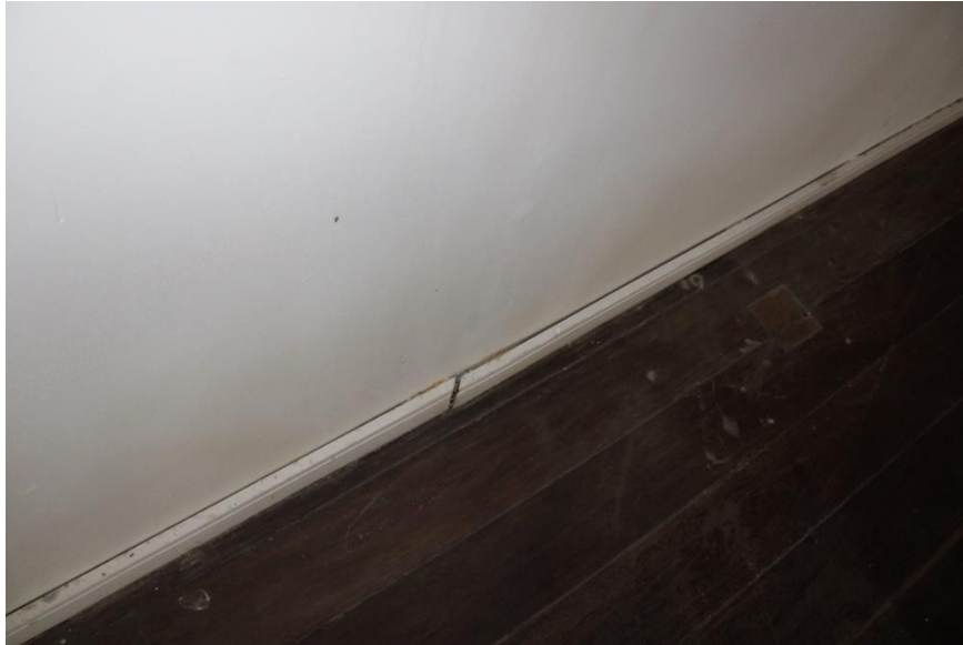
Figura 193 – Rodapé descolando – 3º pavimento
