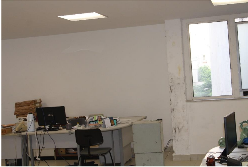
Figura 246 – Manchas de umidade na parede – 1º pavimento ( sala Fabíola)
