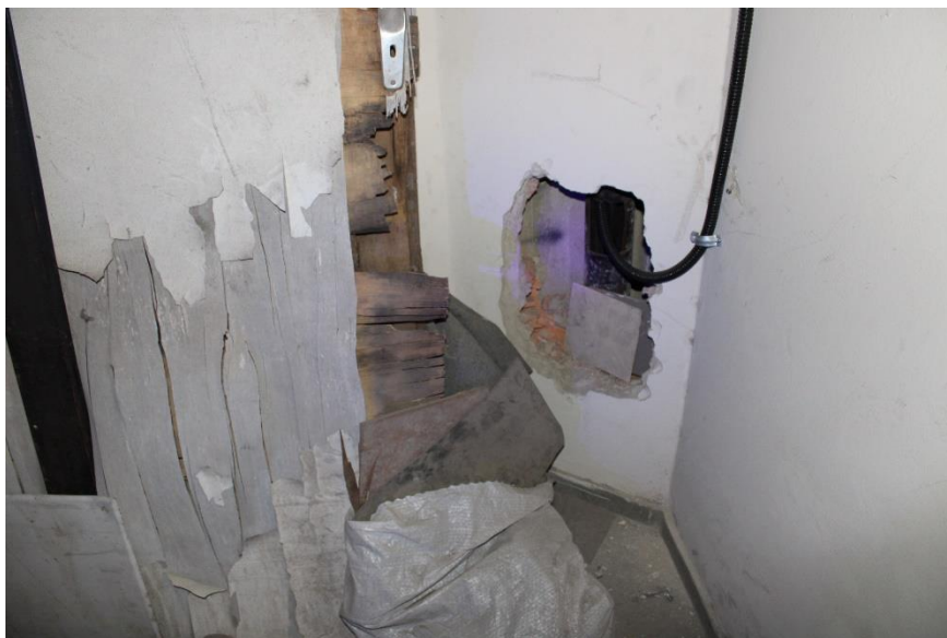
Figura 107 - Vista entulhos na caixa de escada de acesso à casa de máquinas
