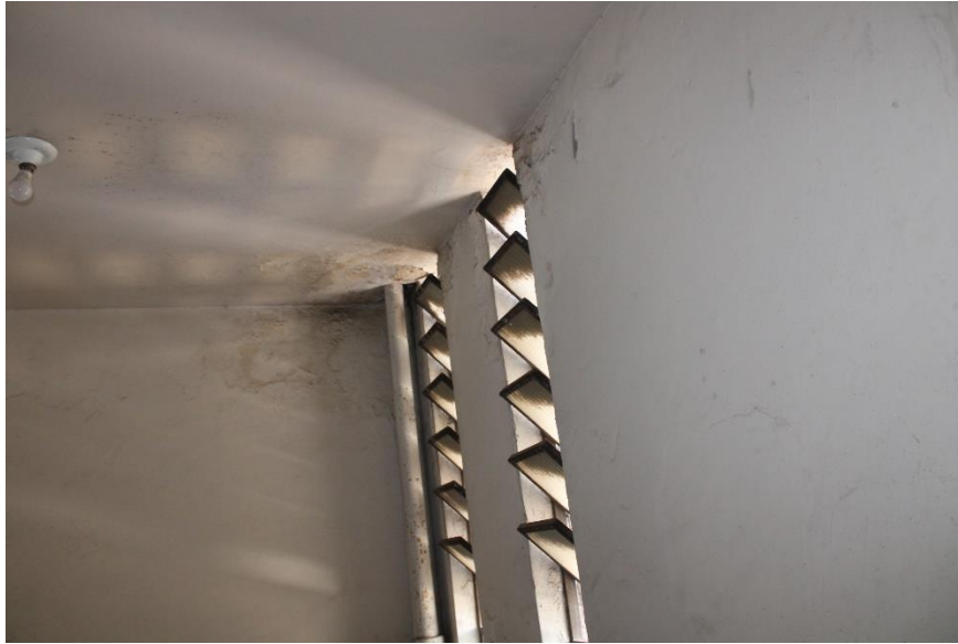
Figura 112 – Manchas de umidade no teto e parede – casa de máquinas
