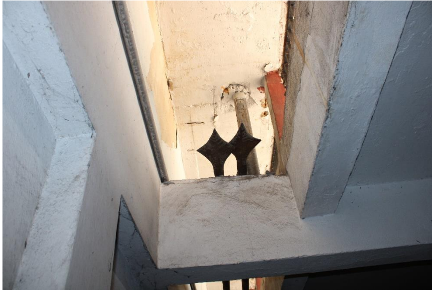
Figura 309 – Descascamento de pintura na parede
