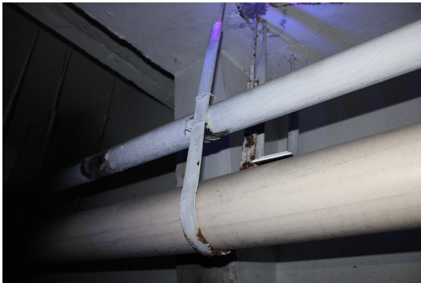
Figura 322 – Fitas oxidadas e presas com fios – garagem
