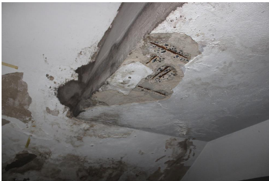
Figura 336 – Ferragem exposta no fundo da laje da escada – rampa garagem
