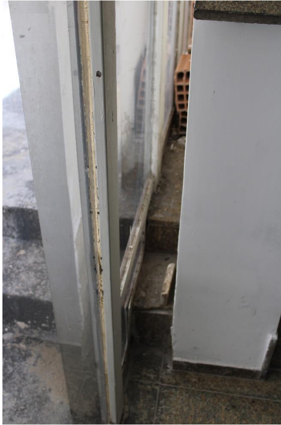
Figura 282 – Detalhe esquadria com pontos de oxidação – pavimento térreo
