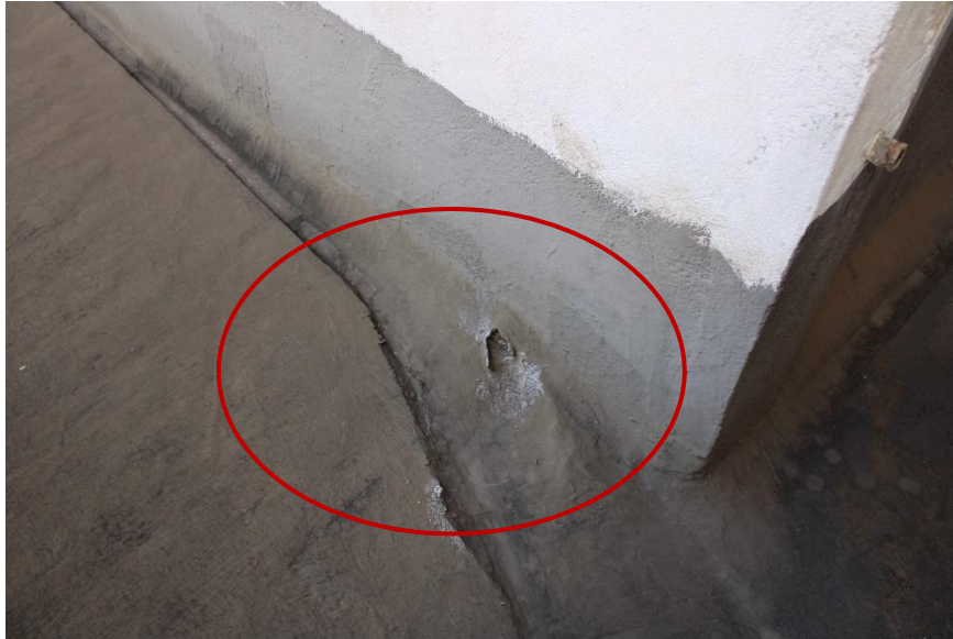
Figura 15 – Vista manta danificada
