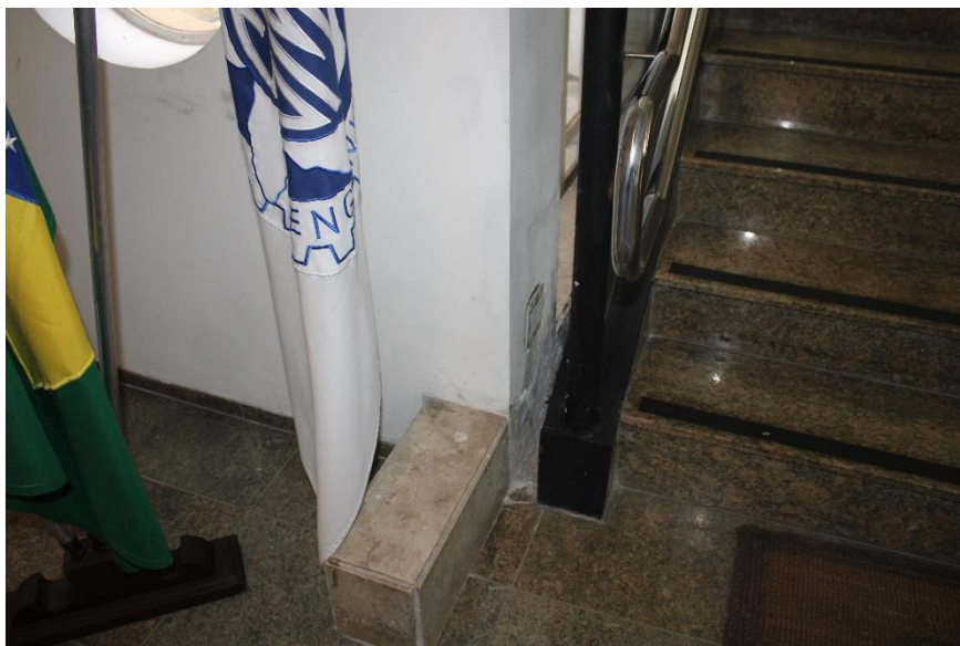
Figura 271 – Evidências de umidade na base da parede a o lado da escada de acesso ao primeiro pavimento
