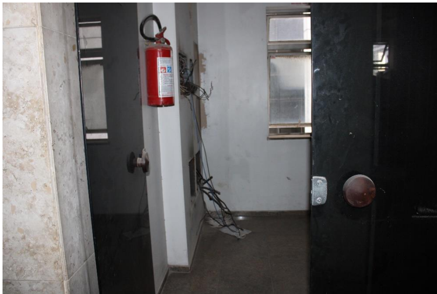
Figura 95 – Fiação exposta no hall de escada
