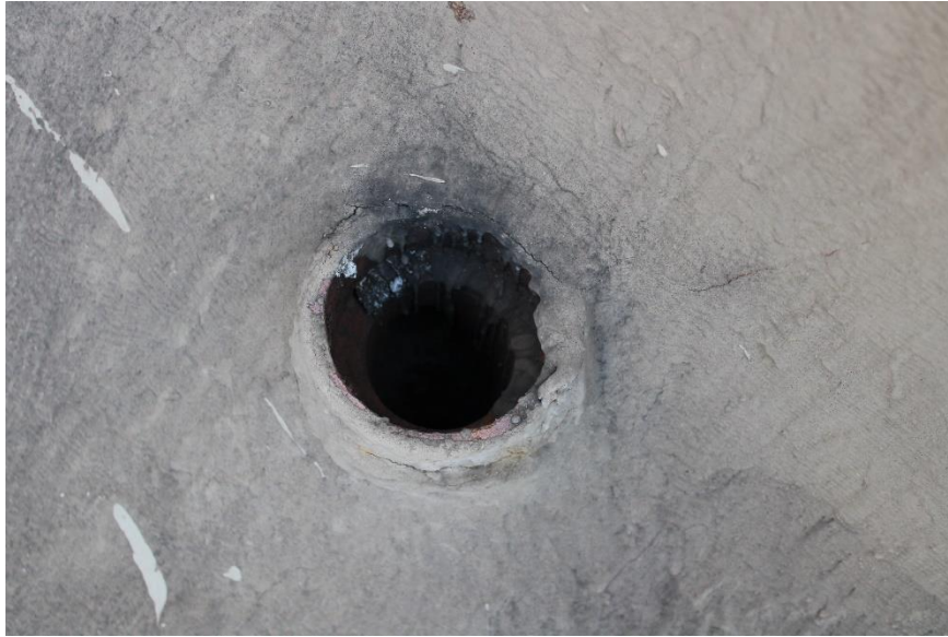
Figura 19 – Vista ralo sem tamponamento adequado – área externa fundos
