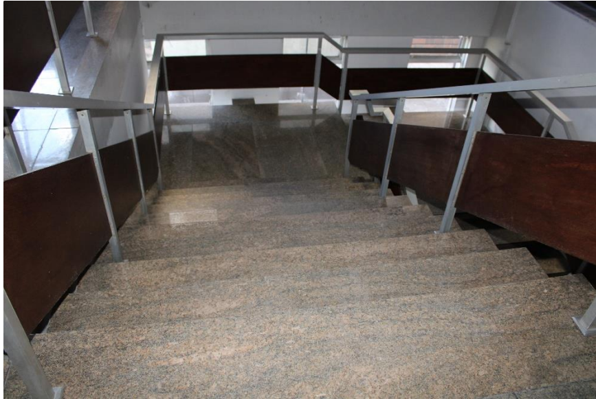
Figura 174 – Escada de acesso ao 3º pavimento sem fita antiderrapante
