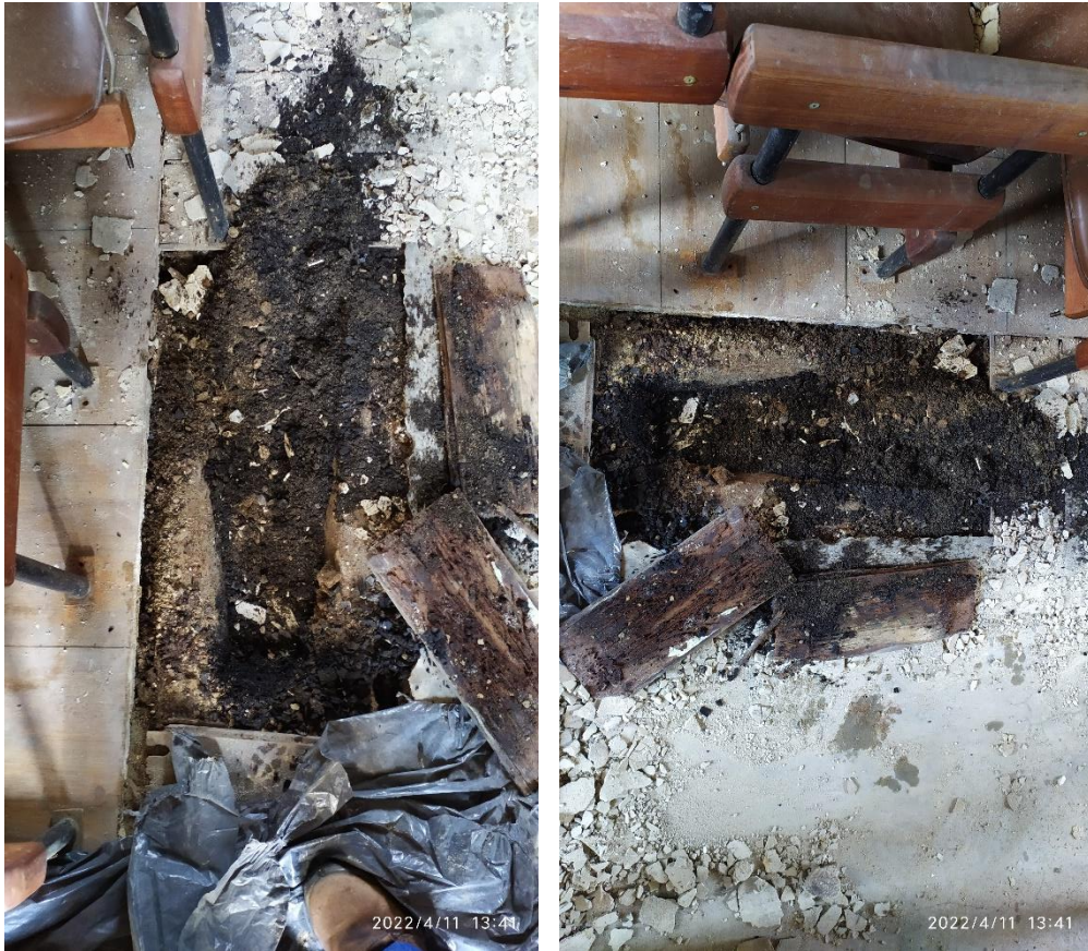
Figura 57 - Vista terra encontrada sob o piso laminado – 6º pavimento
