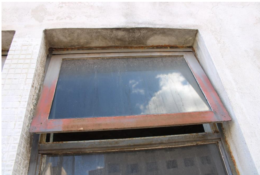
Figura 17 – Vista oxidação da janela e vedação danificada – fachada fundos
