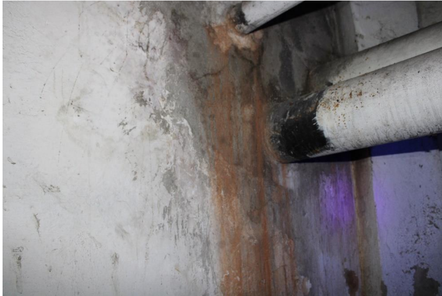
Figura 325 – Manchas de umidade pela parede - garagem
