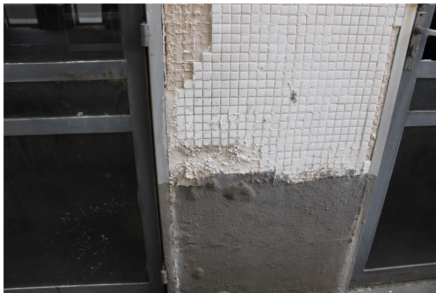
Figura 71 – Descolamento e vesículas de ar na manta
