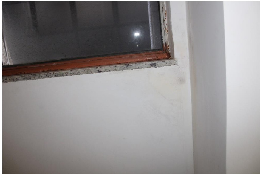
Figura 243 - Manchas de umidade e empolamento de pintura – 1º pavimento
