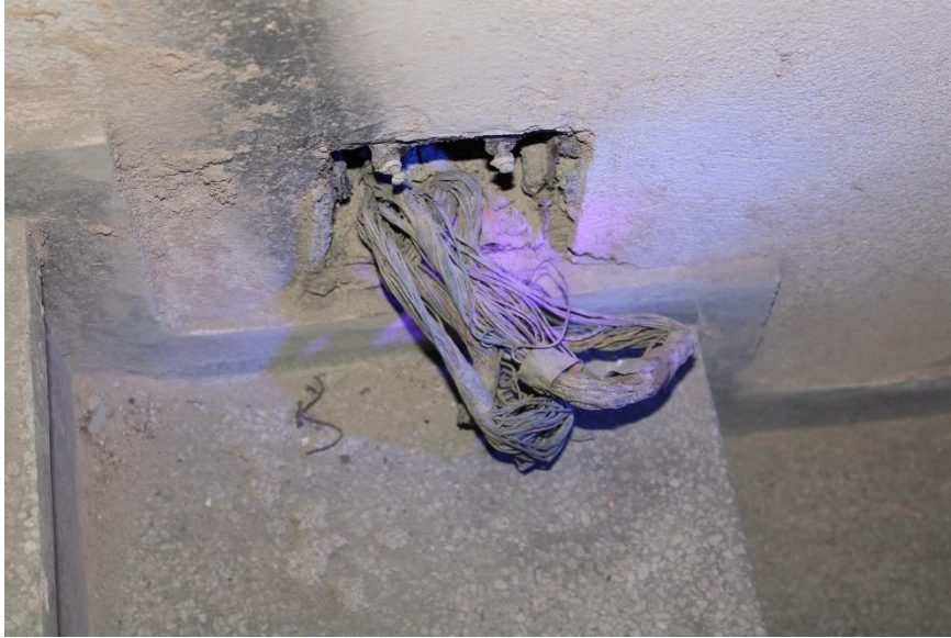
Figura 102 – Fios expostos na caixa de escada
