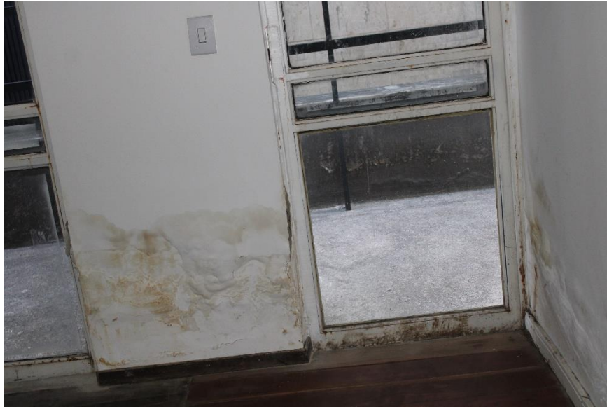
Figura 225 – Vista manchas de umidade na base da parede e oxidação da esquadria metálica – 2º pavimento
