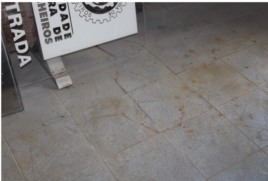
Figura 38 – Piso danificado – sala 6º pavimento (arquivo)
