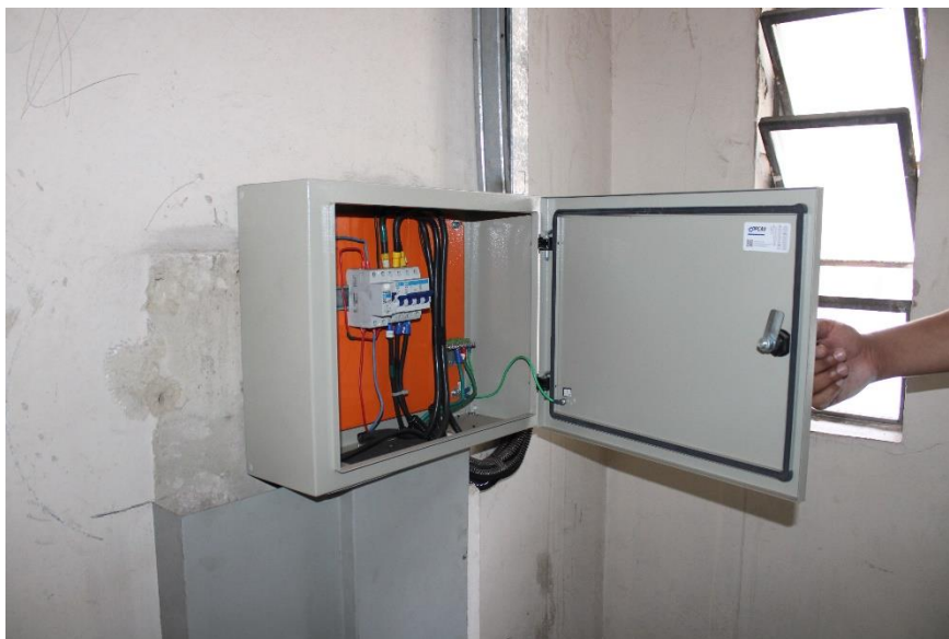
Figura 115 – Vista caixa de disjuntores
