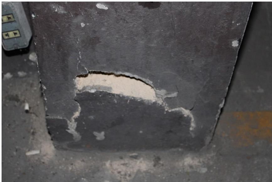
Figura 318 – Deslocamento de massa na base do pilar – garagem
