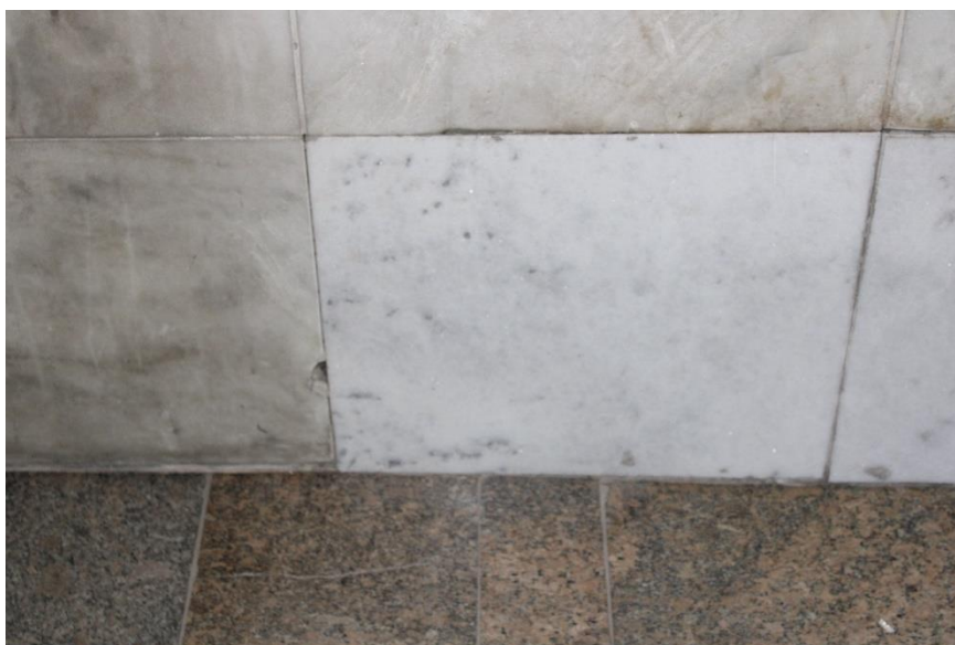
Figura 269 – Revestimento quebrado e com coloração escura e desgaste no rejuntamento – acesso
