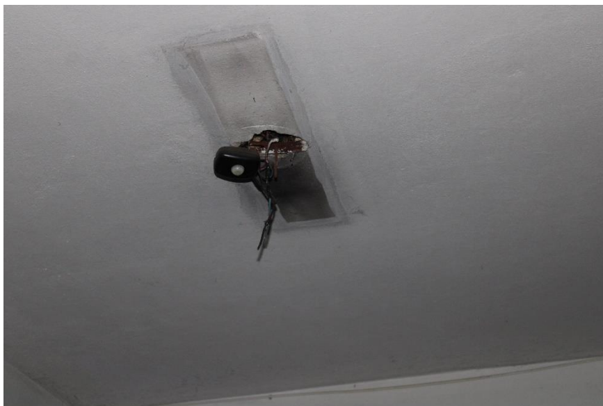
Figura 340 – Fios elétricos expostos
