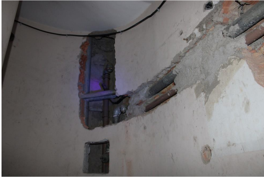
Figura 100 – Vista parcial tubulações passando pela caixa de escada
