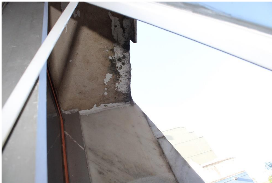
Figura 247 – Manchas de umidade no beiral – 1º pavimento
