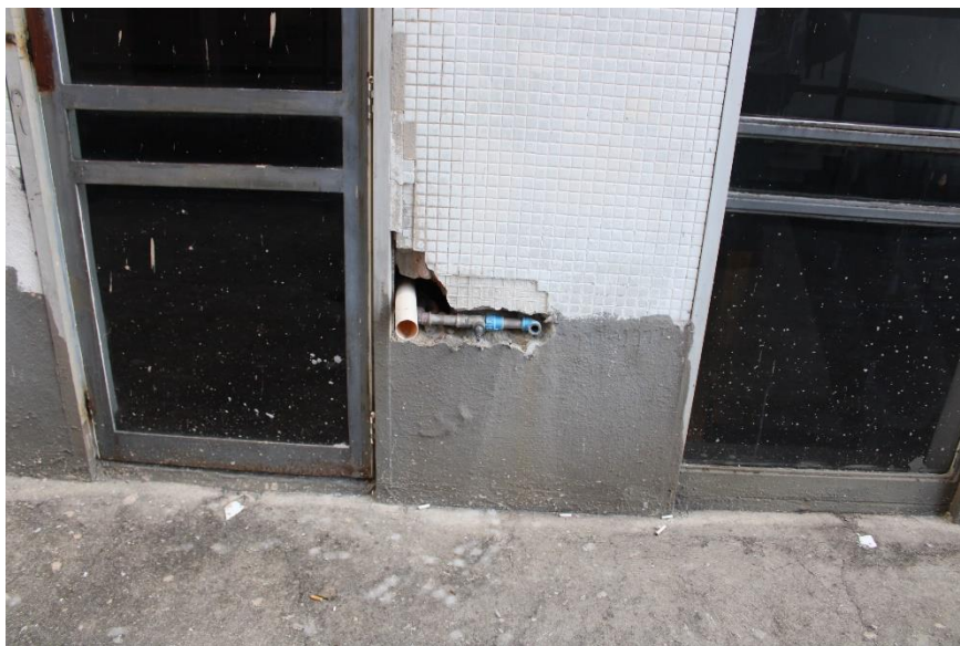
Figura 234 – Tubulação aparente sem o devido fachada – 2º pavimento
