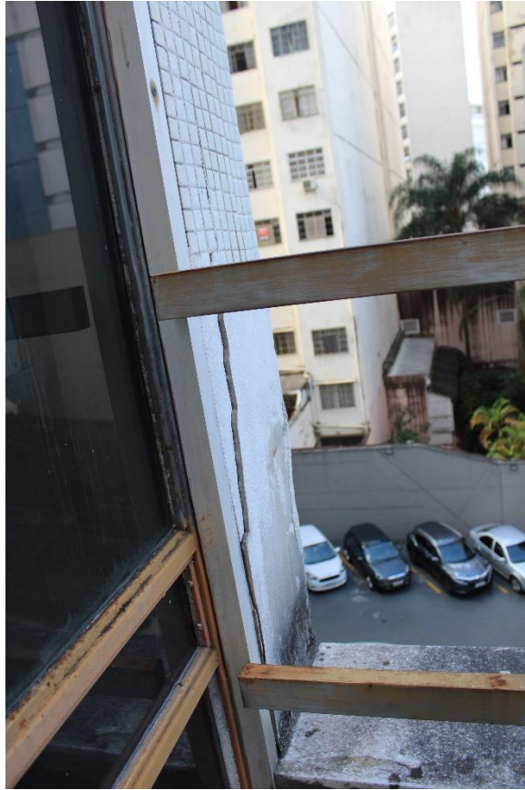
Figura 229 – Deslocamento de massa iminente da fachada fundos – 2º pavimento
