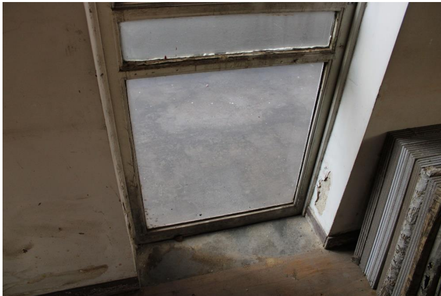
Figura 49 – Vista porta deteriorada – 6º pavimento
