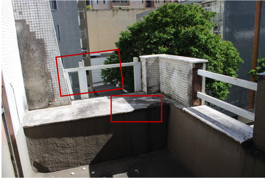
Figura 66 – Parapeito quebrado e guarda-corpo sem vidro
