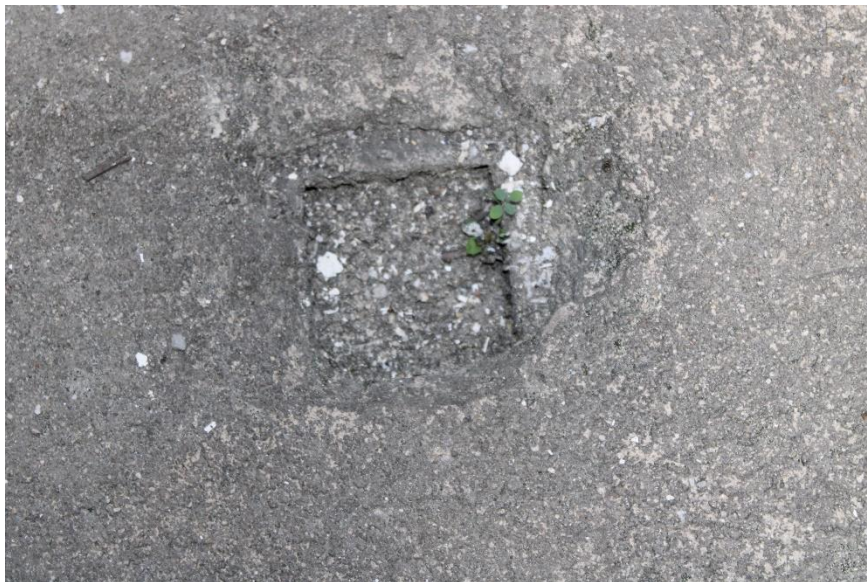
Figura 200 – Ralo obstruído – área externa 3º pavimento
