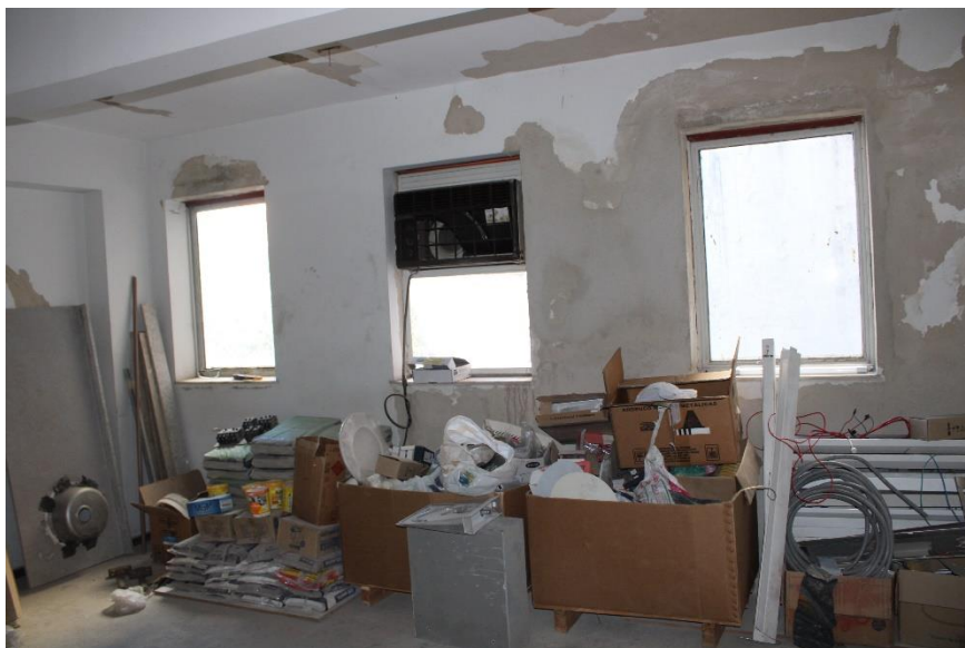
Figura 135 - Descascamento da pintura – 5º pavimento – mezanino
