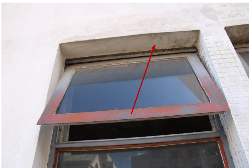
Figura 18 – Vista oxidação da janela e manchas de umidade acima da janela – fachada fundos
