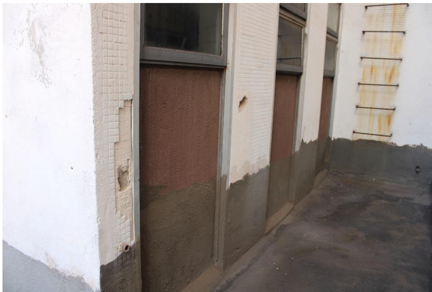
Figura 22 – Vista parcial fachada lateral direita com furo e pontos sem revestimento
