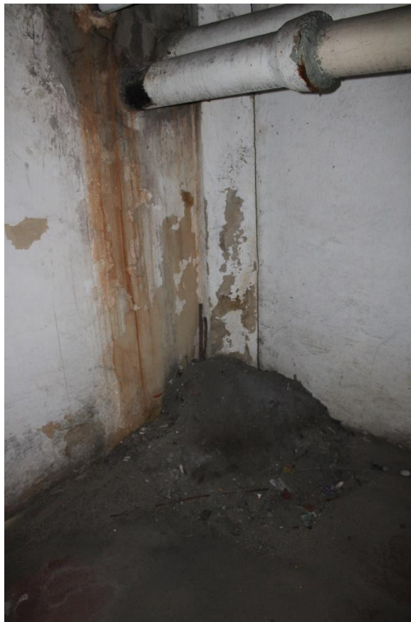
Figura 324 – Vista base da parede e tubulações com emenda utilizando durepoxi – garagem
