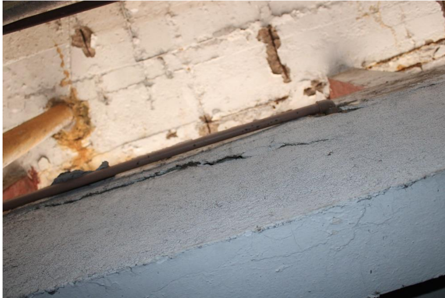
Figura 293 - Ferragem exposta no fundo da laje do jardim – garagem
