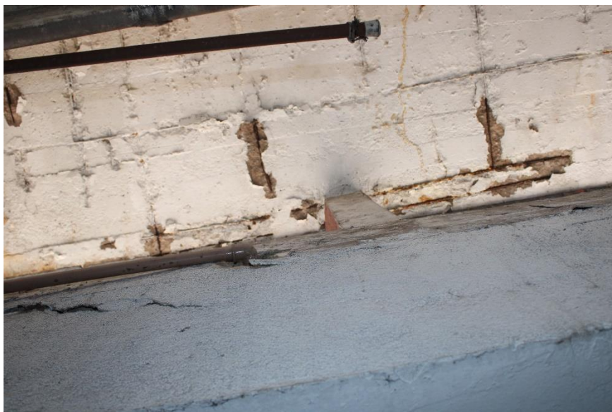
Figura 292 – Ferragem exposta no fundo da laje do jardim – garagem
