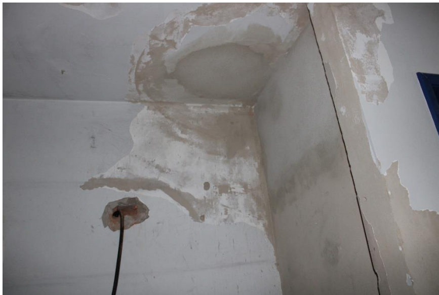
Figura 137 - Descascamento da pintura – 5º pavimento – mezanino
