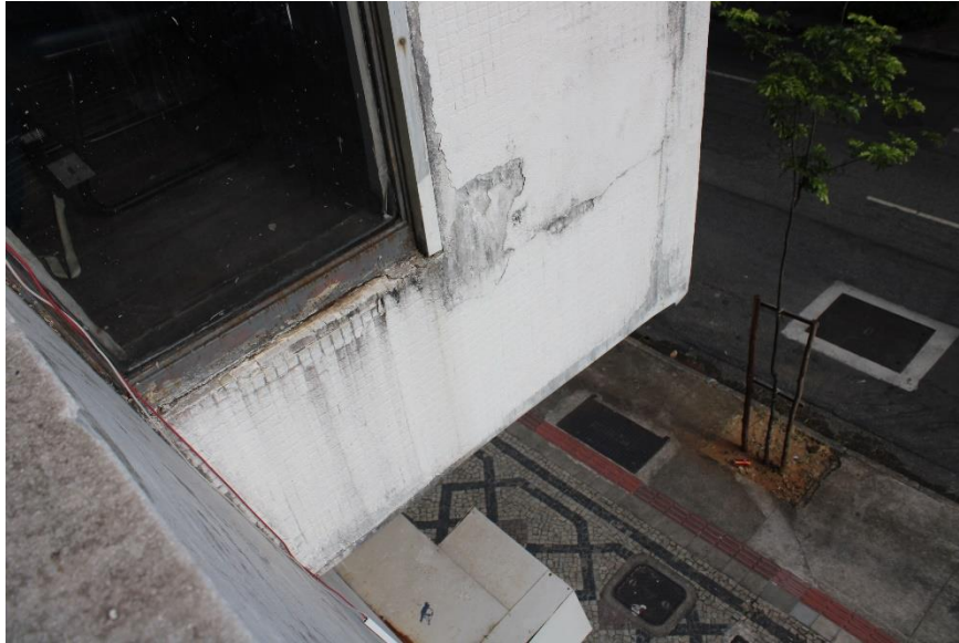
Figura 217 – Vista fachada lateral e esquadria metálica oxidada
