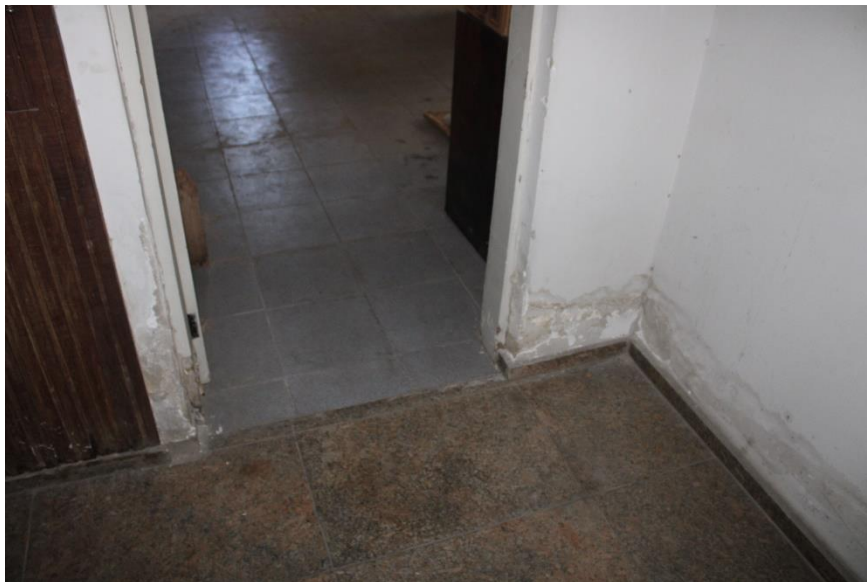
Figura 119 – Umidade na base da parede
