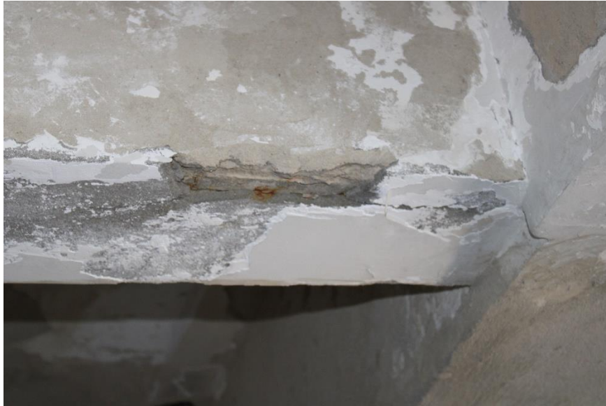
Figura 142 – Reboco e gesso danificado – 5º pavimento – mezanino
