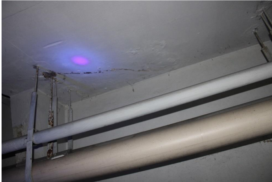
Figura 323 – Trinca na laje e vesículas na pintura – garagem
