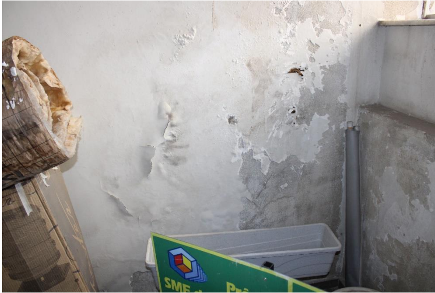
Figura 37 – Vista umidade nas paredes com descascamento de pintura – sala 6º pavimento (arquivo)
