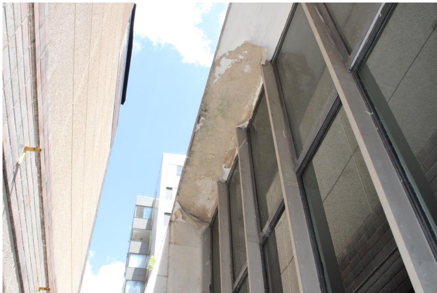
Figura 277 – Descascamento de pintura no beiral da fachada
