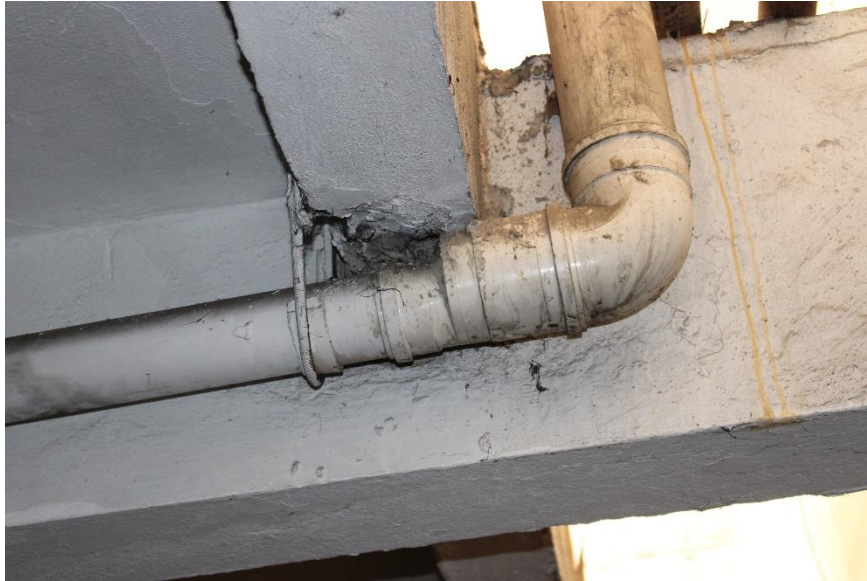
Figura 311 - Viga quebrada para passagem da tubulação - garagem
