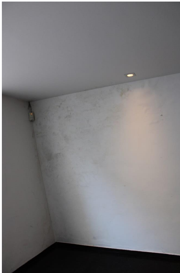
Figura 273 – Manchas de umidade e mofo na parede- térreo
