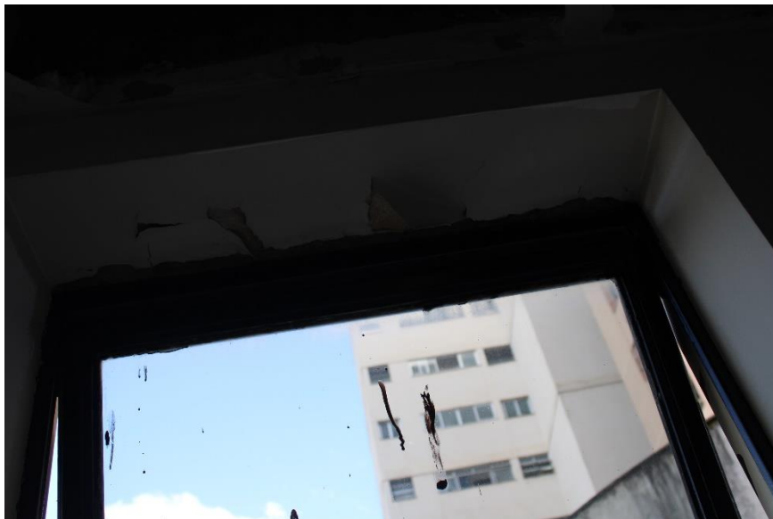
Figura 171 – Descascamento de pintura – 4º pavimento
