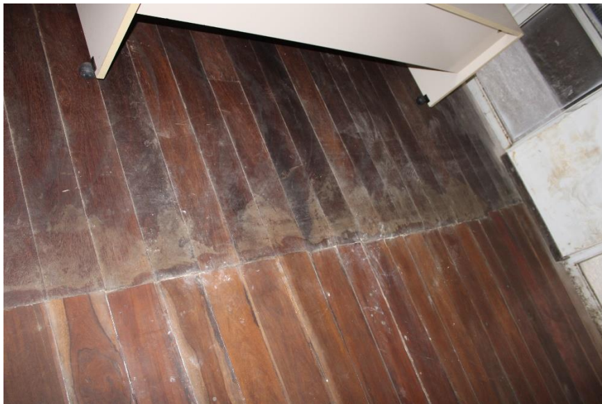
Figura 196 – Piso danificado - 3º pavimento
