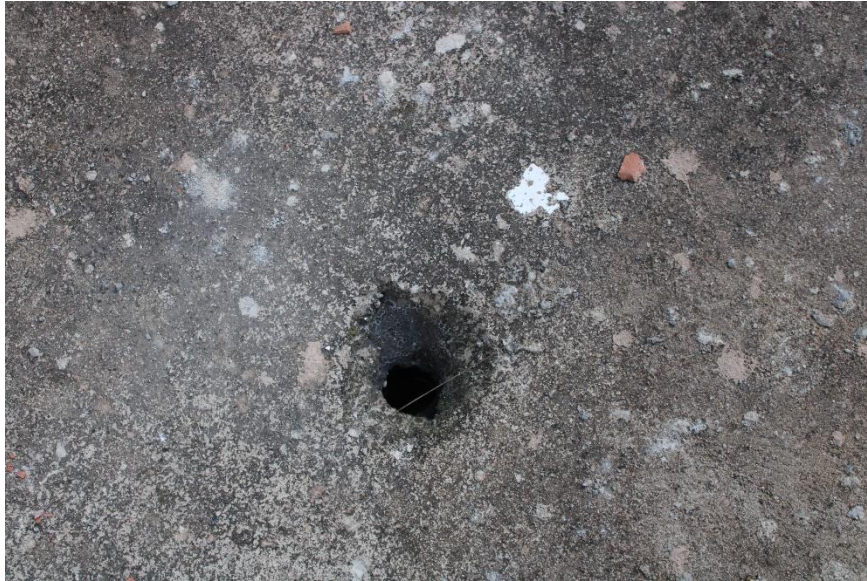
Figura 235 – Ralo sem vedação adequada – 2º pavimento
