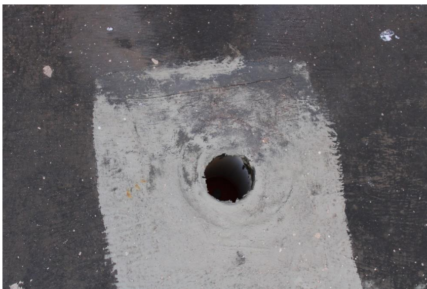
Figura 10 – Vista ralo no piso sem tamponamento adequado
