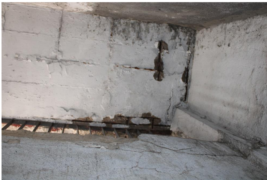
Figura 294 - Ferragem exposta no fundo da laje e mapeamento de fissuras na viga – garagem
