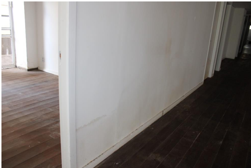
Figura 187 – Mancha de umidade na parede – 3º pavimento
