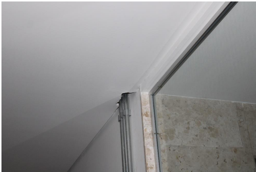
Figura 226 – Furo no forro de gesso- 2º pavimento
