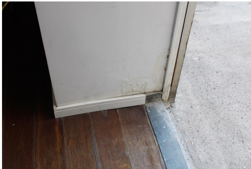
Figura 228 – Empolamento da pintura e manchas de umidade na base da parede – 2º pavimento
