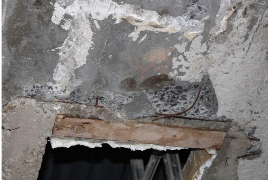
Figura 48 – Ferragem exposta na laje – 6º pavimento
