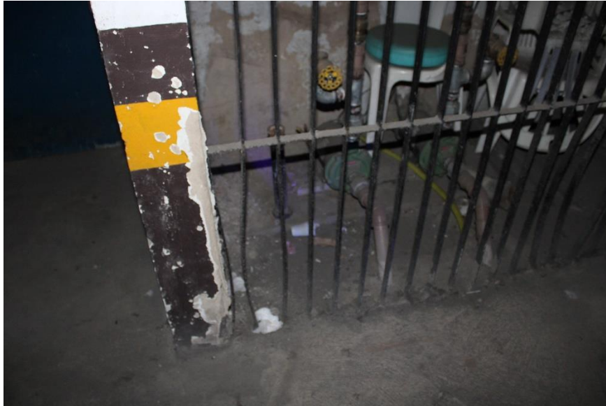
Figura 305 – Descascamento de pintura na base da parede – garagem
