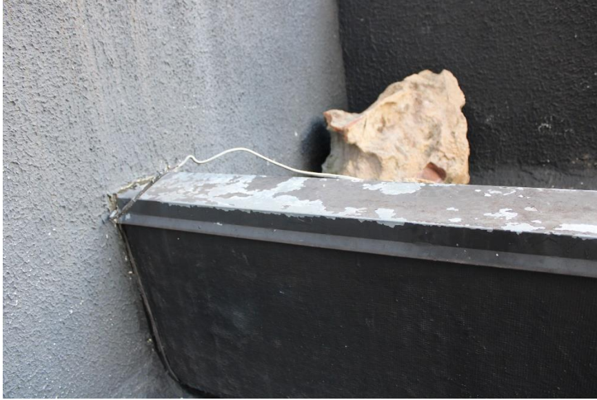
Figura 258 – Fio exposto sobre o guarda-corpo – área externa fundos
