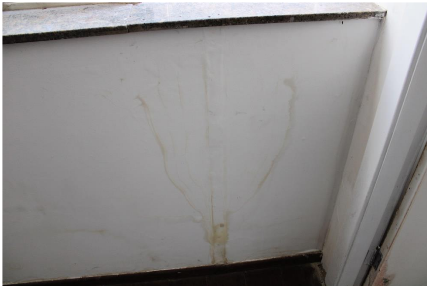
Figura 183 – Manchas de umidade na parede – 3º pavimento
