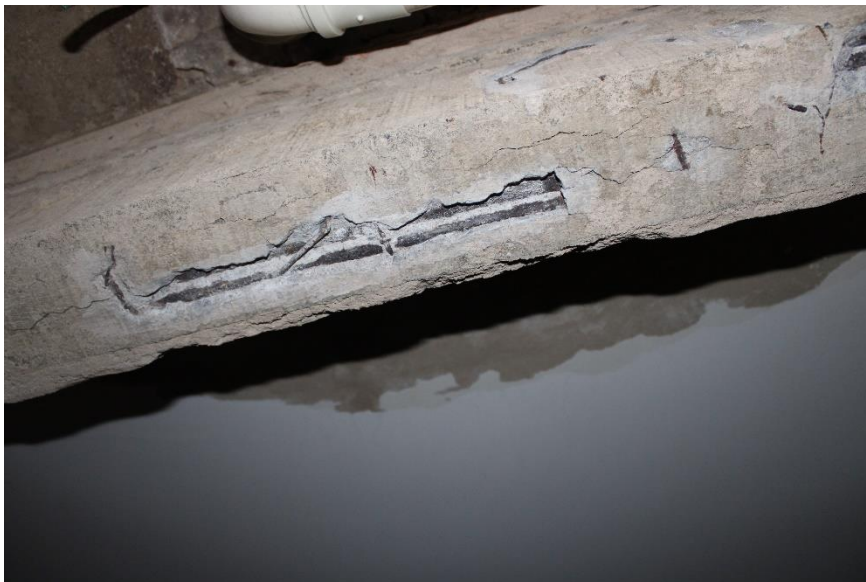
Figura 125 – Ferragem exposta no fundo da viga
