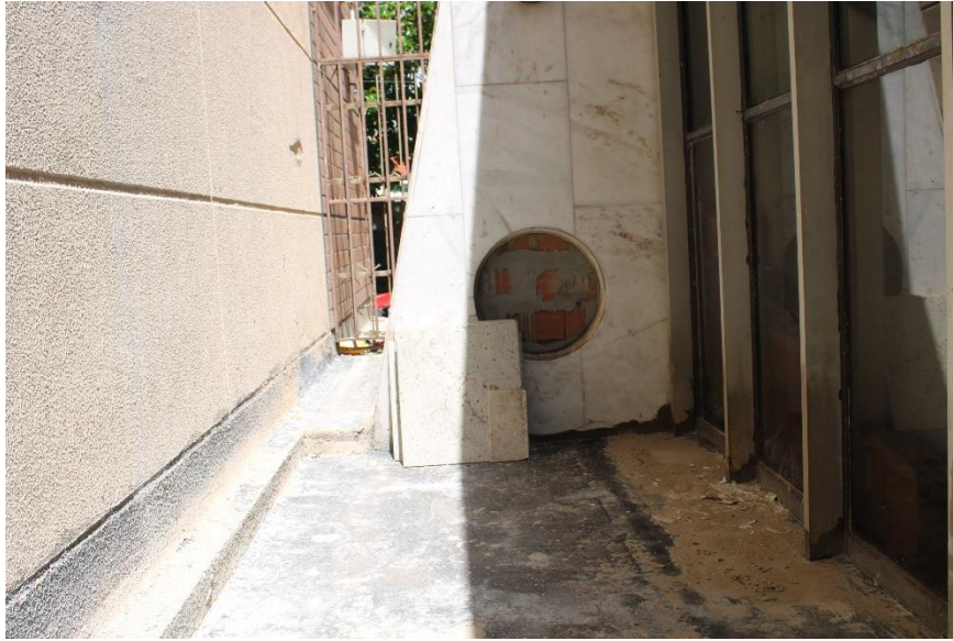
Figura 278 – Janelas na fachada sem a vedação adequada e estruturas metálicas com pontos de oxidação
