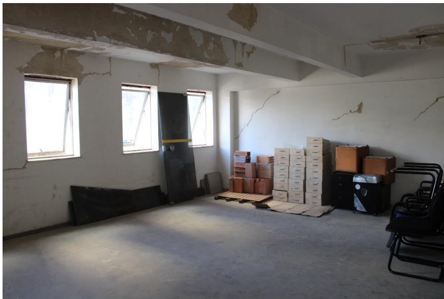
Figura 139 - Descascamento da pintura e cortes na parede – 5º pavimento – mezanino
