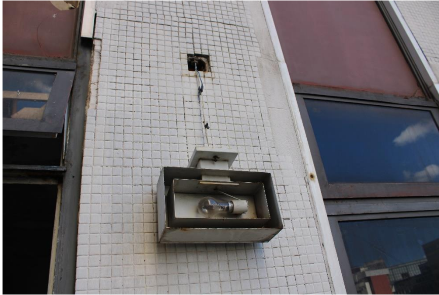
Figura 27 – Fiação elétrica exposta
