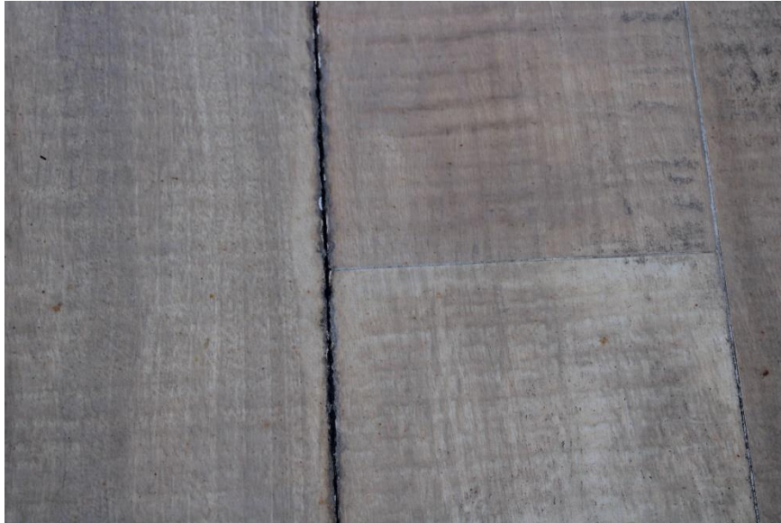
Figura 260 – Desgaste no rejuntamento do piso - área externa fundos
