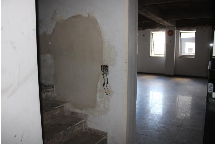
Figura 176 – Fios expostos – caixa de escada 3º pavimento
