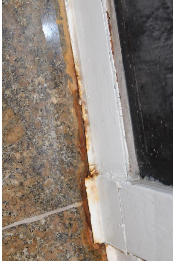
Figura 264 – Pontos de oxidação na estrutura metálica
