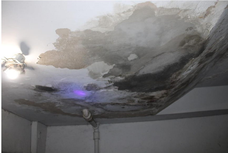
Figura 335 – Evidências de umidade no fundo da laje da escada – rampa garagem
