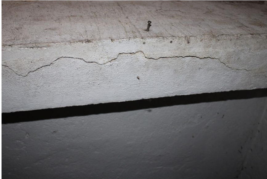
Figura 295 – Trinca no fundo da viga
