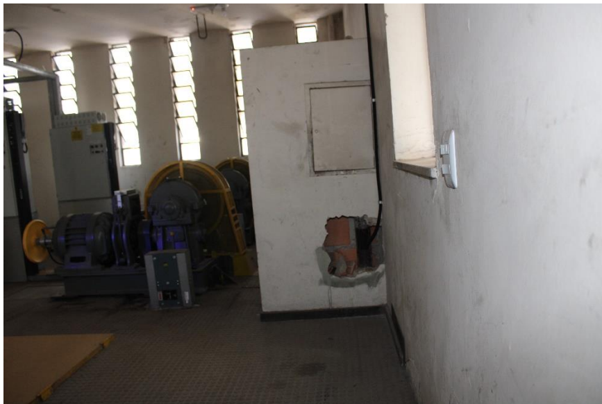
Figura 109 – Buracos na alvenaria na casa de máquinas
