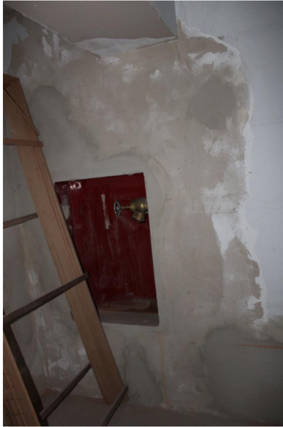
Figura 138 – Vista caixa de hidrante
