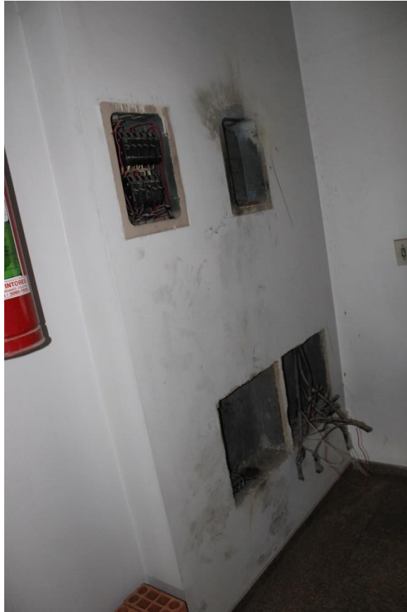
Figura 154 - Caixa sem tampa com acondicionamento em desconformidade com a NBR 5410 - caixa de escada 5º ao 4º pavimento
