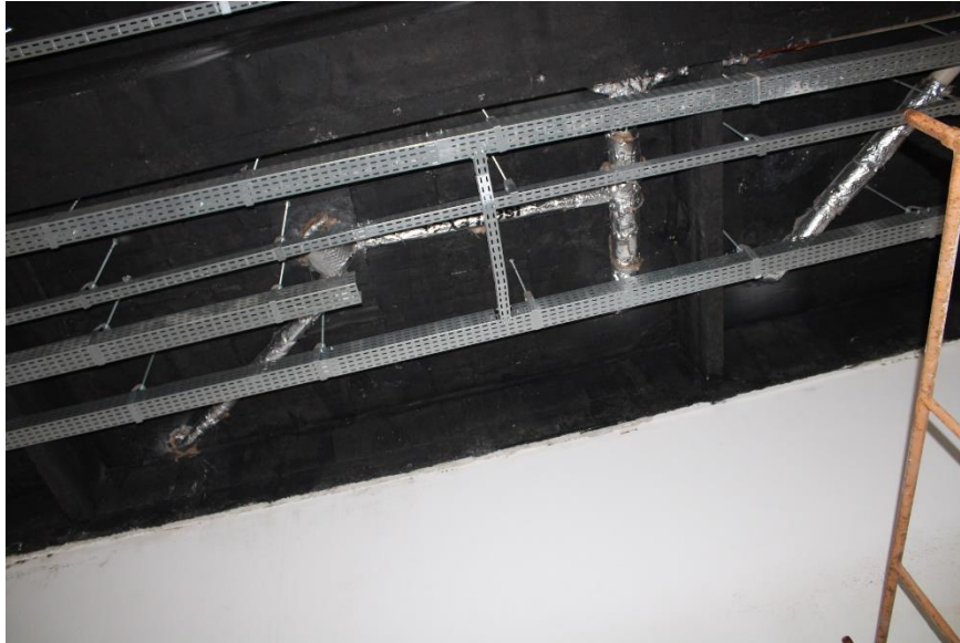
Figura 166 – Vista tubulação coberta com manta de alumínio - 4º pavimento
