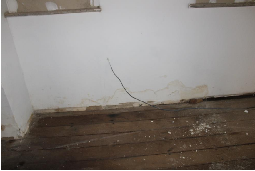
Figura 164 – Mancha de umidade e fio exposto na base da parede - 4º pavimento
