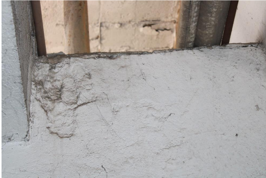
Figura 289 – Vista trinca no topo da viga – garagem
