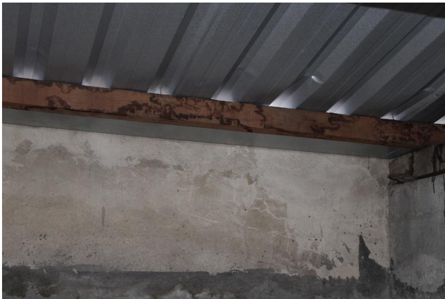
Figura 91 – Vista madeiramento com manchas telhado e parede
