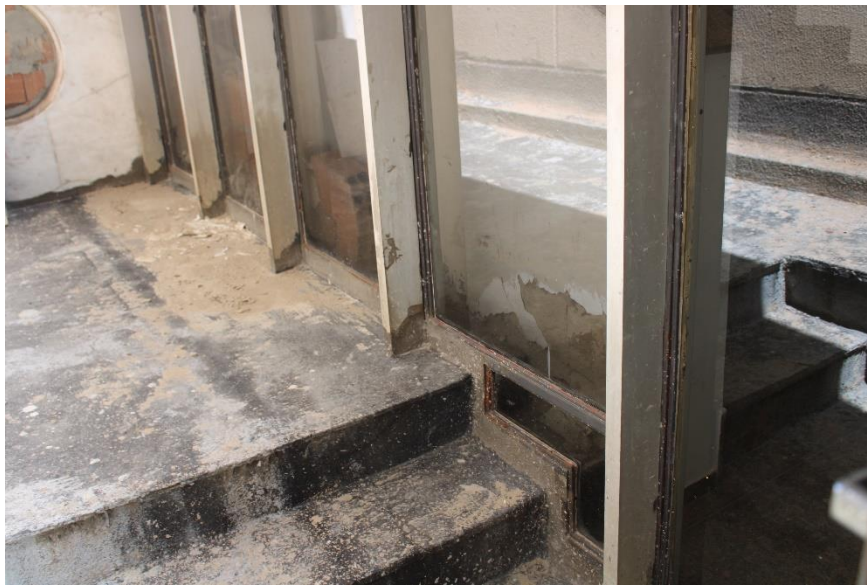
Figura 279 – Vista estruturas metálicas da fachada com pontos de oxidação
