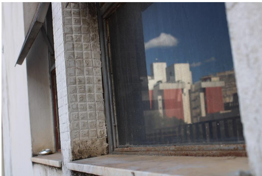
Figura 16 – Vista oxidação da janela e vedação danificada – fachada fundos
