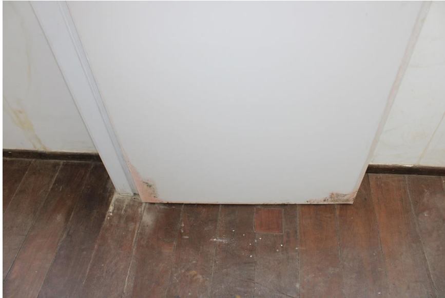
Figura 184 – Presença de musgos na porta – 3º pavimento
