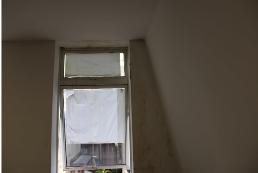
Figura 250 - Manchas de umidade na parede – 1º pavimento
