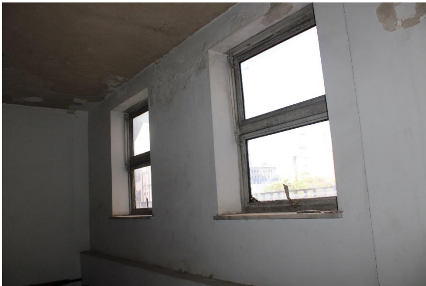
Figura 32 – Marcas de umidade e descascamento de pintura nas paredes – sala 6º pavimento
