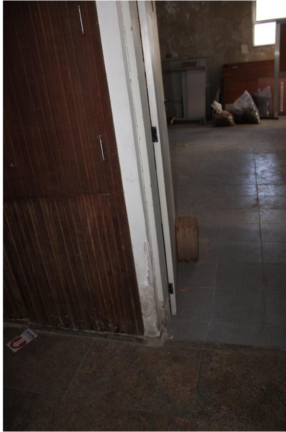
Figura 39 – Umidade na base da parede – sala 6º pavimento (arquivo)
