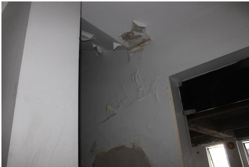
Figura 177 – Descascamento de pintura - caixa de escada 3º pavimento
