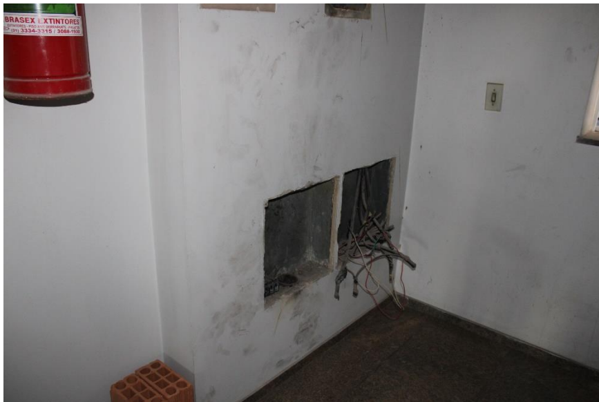
Figura 175 – Fios expostos e sujidades nas paredes – caixa de escada 4º para o 3º pavimento
