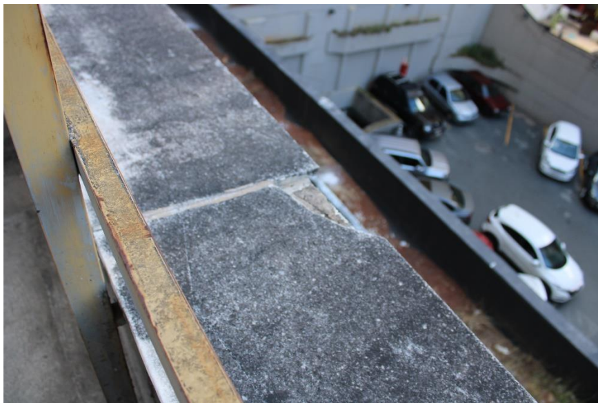
Figura 230 – Chapéu de muro quebrado – 2º pavimento
