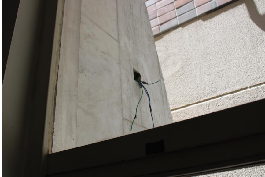
Figura 276 – Fios expostos na fachada
