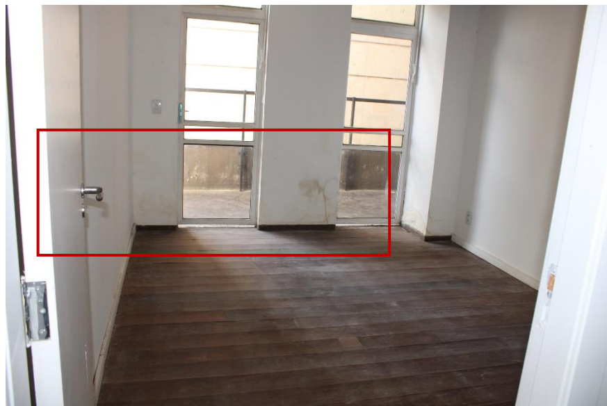
Figura 192 – Manchas de umidade na parede – 3º pavimento
