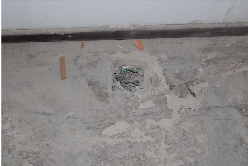
Figura 132 – Fios expostos no piso – 5º pavimento – mezanino
