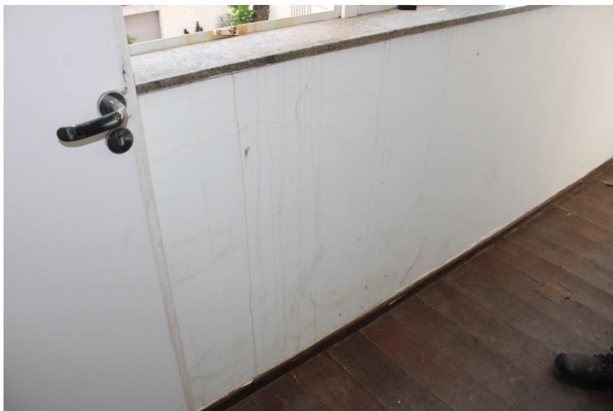
Figura 185 – Manchas de umidade na parede e peitoril sem a devida inclinação – 3º pavimento
