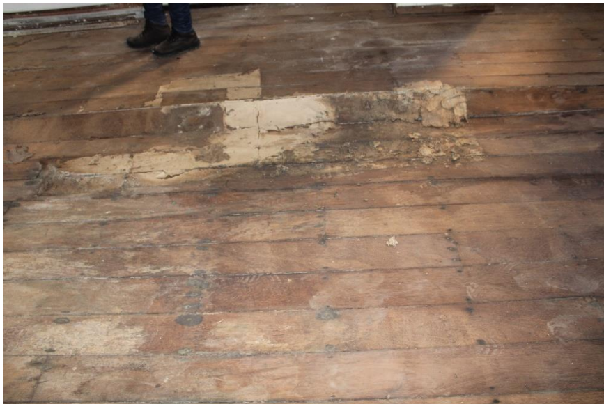
Figura 161 – Vista parcial piso degradado - 4º pavimento
