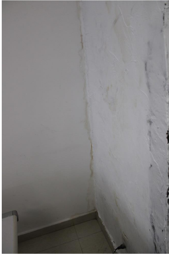
Figura 248 – Manchas de umidade na parede – 1º pavimento
