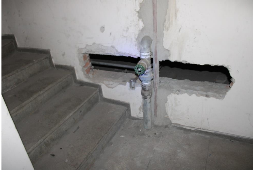
Figura 106 – Buracos na parede da caixa de escada
