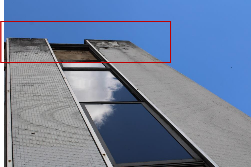
Figura 219 – Desplacamento do revestimento no topo da fachada lateral direita e terço sem vidro
