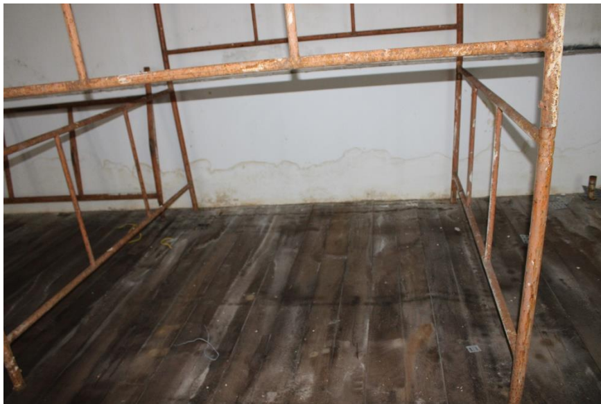
Figura 165 - Mancha de umidade na base da parede e no piso - 4º pavimento
