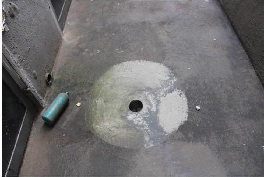
Figura 78 – Vista ralo sem fechamento adequado
