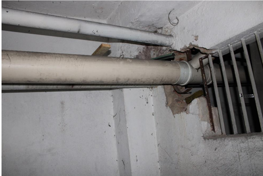
Figura 319 – Paredes quebradas para a passagem da tubulação – garagem
