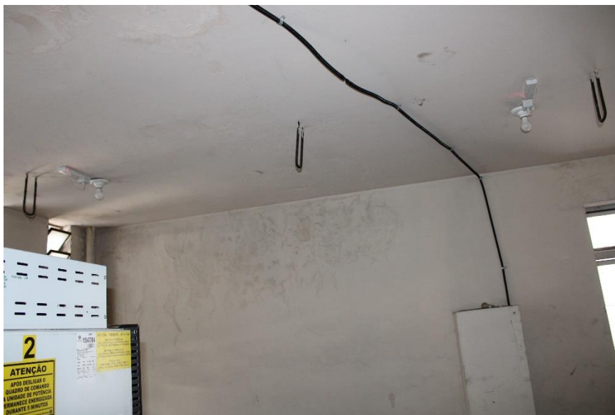
Figura 113 - Manchas de umidade no teto e parede – casa de máquinas
