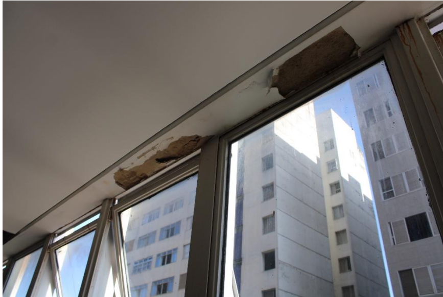
Figura 186 – Descascamento de pintura e deslocamento de massa acima da janela – 3º pavimento
