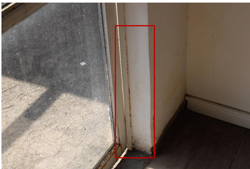
Figura 189 – Trinca vertical ao lado da porta – 3º pavimento
