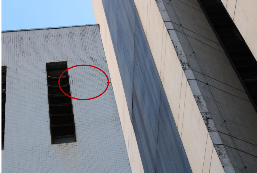
Figura 25 – Fachada fundos com deslocamento da pastilha
